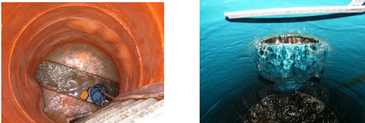
Bild 8 Polymere Beschichtungen in Bereichen, an denen der Verbund mit Trennmittel planmäßig geschwächt wurde: Blasenbildung mit fortschreitender Ablösung (links) und Aufreißen der Beschichtung (rechts)
