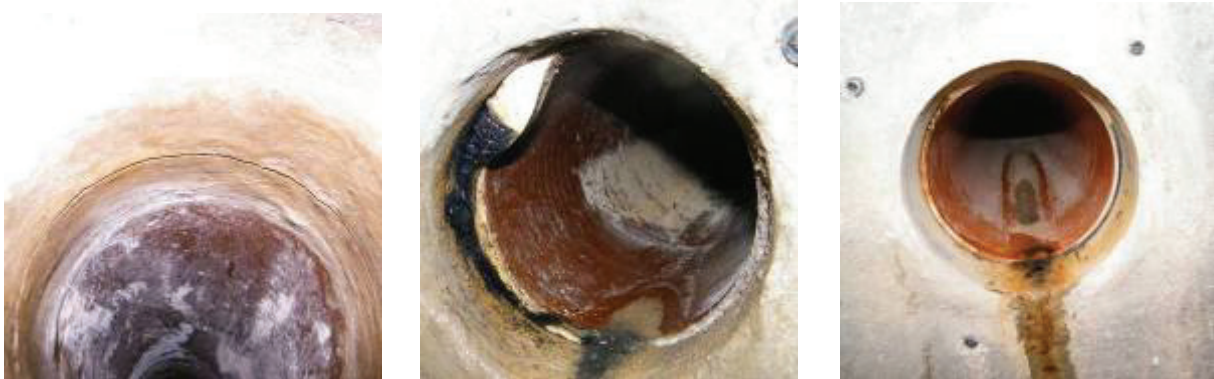
Abb. 3: Rissbildungen in der oberen Mörtelschicht („Injektionswiderlager“, links); Verfärbungen bzw. Ausblühungen im Sanierungsmaterial infolge von Undichtigkeiten (Mitte und rechts)
