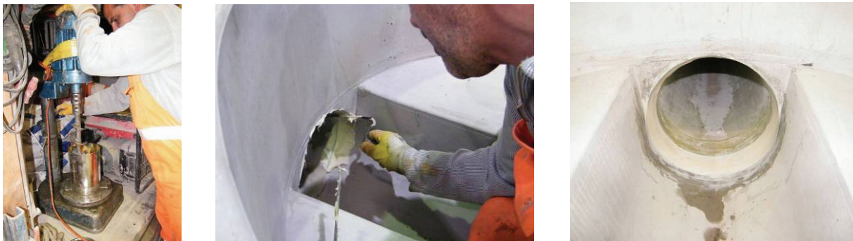
Abb. 40: Anmischen des Epoxidharzes (links); Auftragen des Epoxidharzes an der Anbindung (mittig); Anbindung mit Epoxidharz nach Fertigstellung (rechts)
