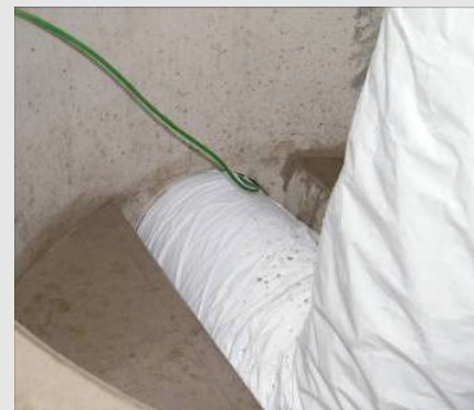
Temperatursensor für die Überprüfung der Aushärtetemperatur
