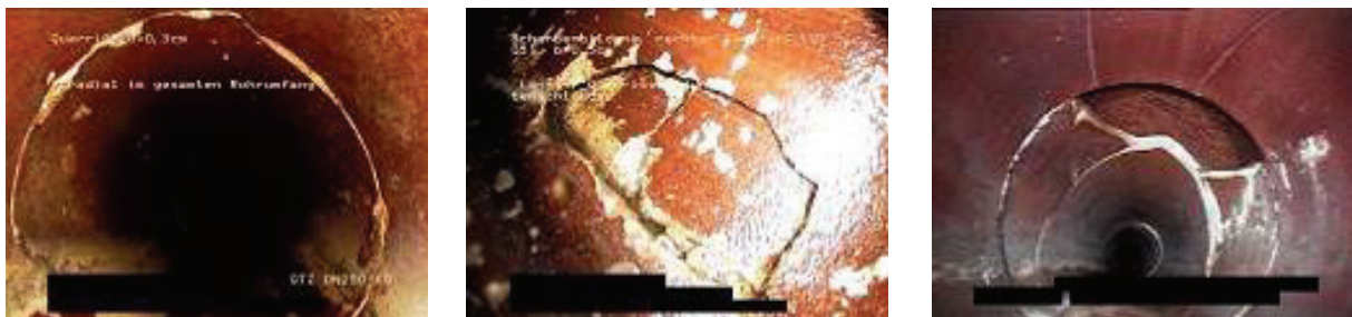
Abb. 17: ortlich begrenzte Schadensbilder im Kanal (Beispiele); umlaufender Querriss (links); Scherbenbildung (Mitte); fehlendes Wandungsteil (rechts)
