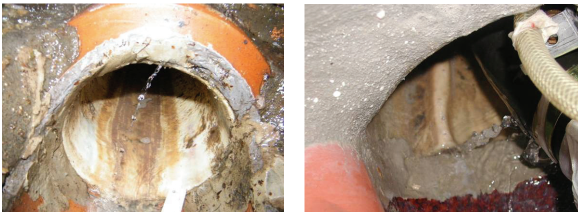
Abb. 28: Undichte Schachtanbindungen (Beispiele)
