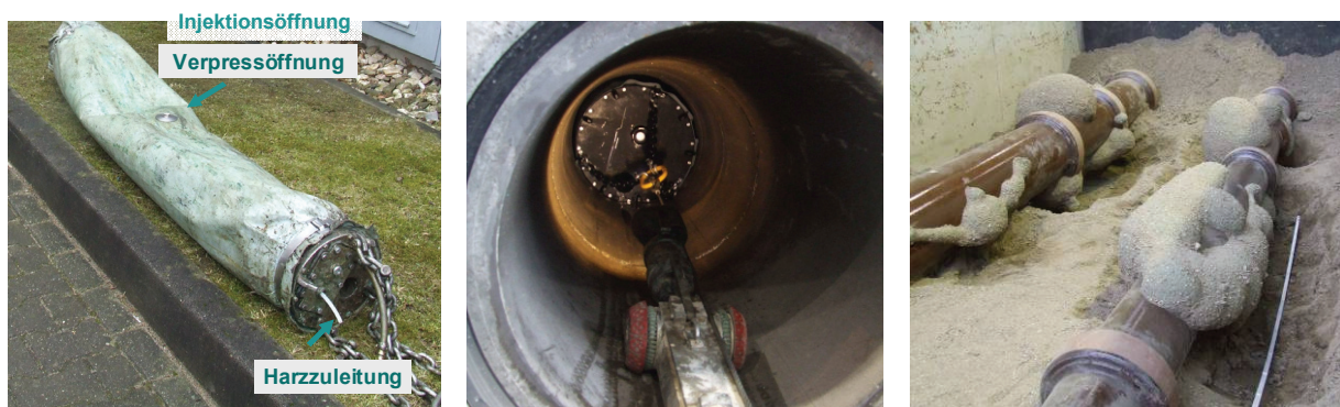
Abb. 21: Beispiel für einen Injektionspacker (links); Injektionspacker im Kanal (Mitte); freigelegte Injektionskörper in der IKT-Versuchshalle (rechts)
