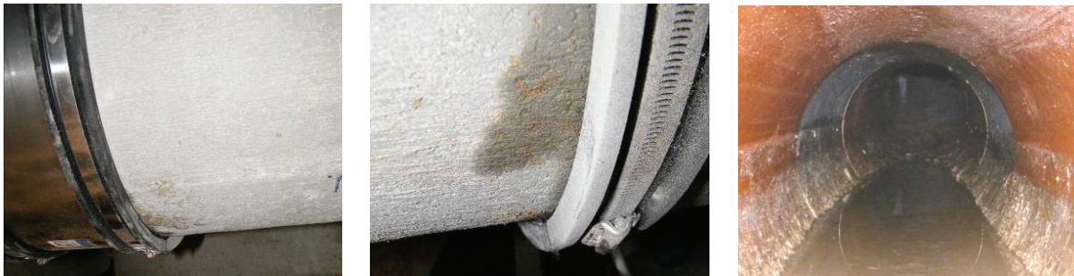
Abb. 32: Betondurchfeuchtung an einer fachgerecht montierten Manschettendichtung während der Füllstandsprüfungen (links und Mitte); Innenansicht eines Werkstoffübergangs mit Manschettendichtung (rechts)
