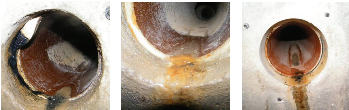
Abb. 48: Verfarbungen bzw. Ausbluhungen im Sanierungsmaterial infolge von Undichtigkeiten (Beispiele)
