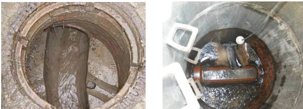
Abb. 55: Klarer Abfluss in den Messschächten als mögliches Indiz für Fremdwasser
