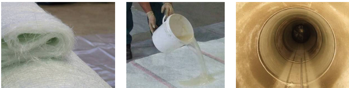
Abb. 18: Trägermaterial für Kurzliner vor der Harzimprägnierung (links); Harzimprägnierung des Trägermaterials (Mitte); eingebauter Kurzliner im Kanal (rechts)
