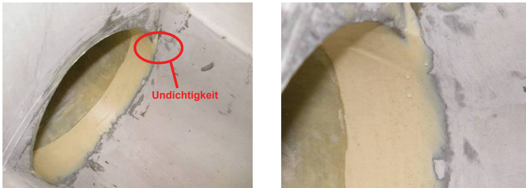
Abb. 41: Undichtigkeit an einer der beiden Schachtanbindungen mit Epoxidharz
