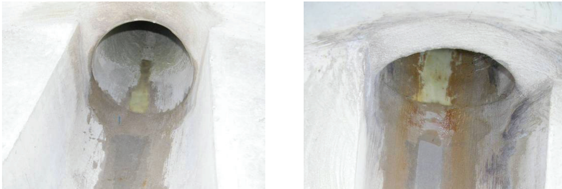
Abb. 39: Undichtigkeiten an Mörtelanbindung 1 (links) und 2 (rechts) bei Befüllung
