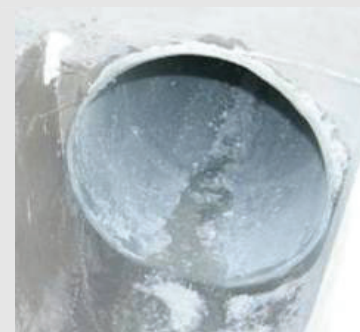
Wassereintritt durch Ringspalt
