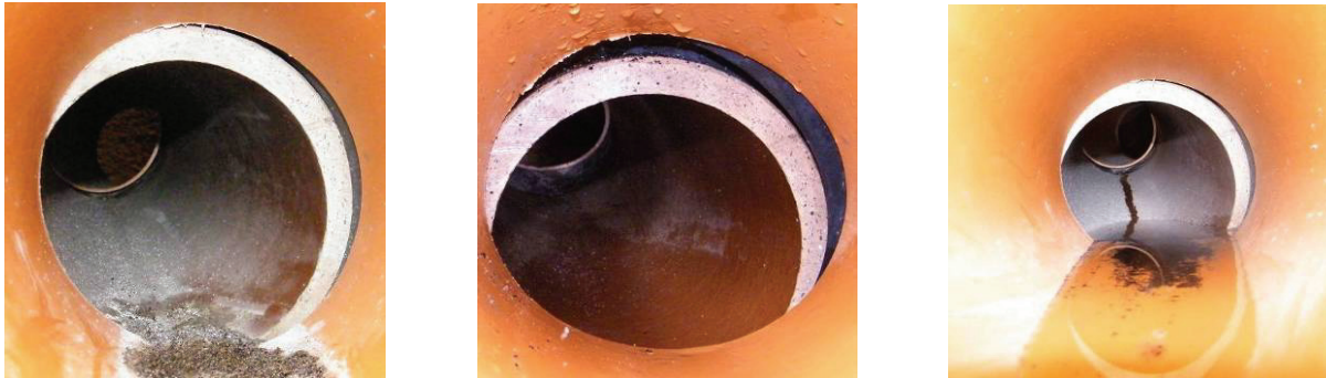
Abb. 33: Werkstoffwechsel von Steinzeug auf PVC im Großversuchsstand, Zustand vor der Flutung des Versuchsstandes (links) und ca. 2,5 Monate nach der Flutung bei einem konstanten Außenwasserdruck von ca. 0,21 bar (Mitte); Undichtigkeiten in einer Haltung DN 150 mit 2 Kupplungen (rechts)
