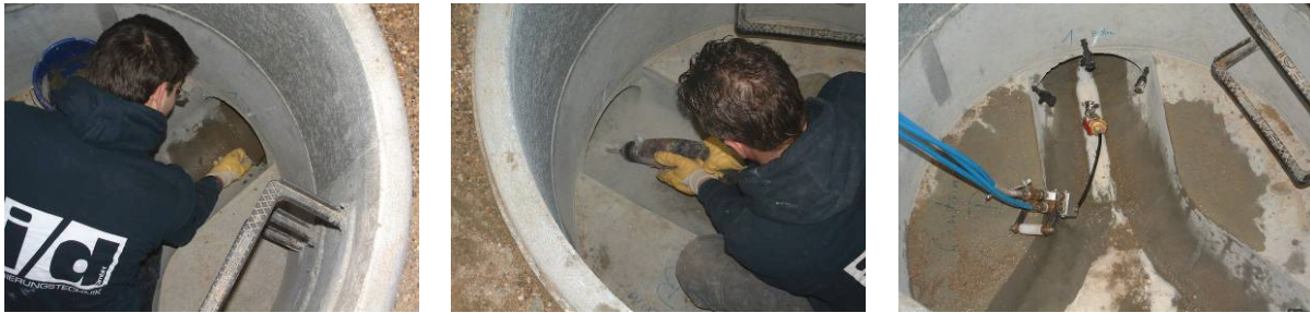
Abb. 29: Verschluss des Fugenspaltes mit Blitzzement (links); Anbringen von Bohrungen für Bohrpacker (Mitte); Harzinjektion über untersten Bohrpacker (rechts)
