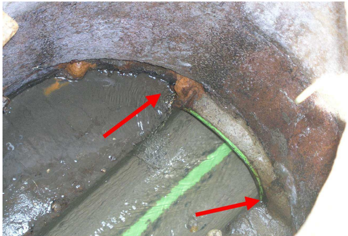
Bild 125: Fremdwassereintritt im Bereich der Berme und Rohreinbindung eines Inliners (253)
