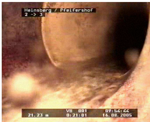
Bild 107: Wasserzutritt durch einen Hausanschluss in der Haltung HE001S0485 im Pfeifershof in Heinsberg (Hundemtal) (242)
