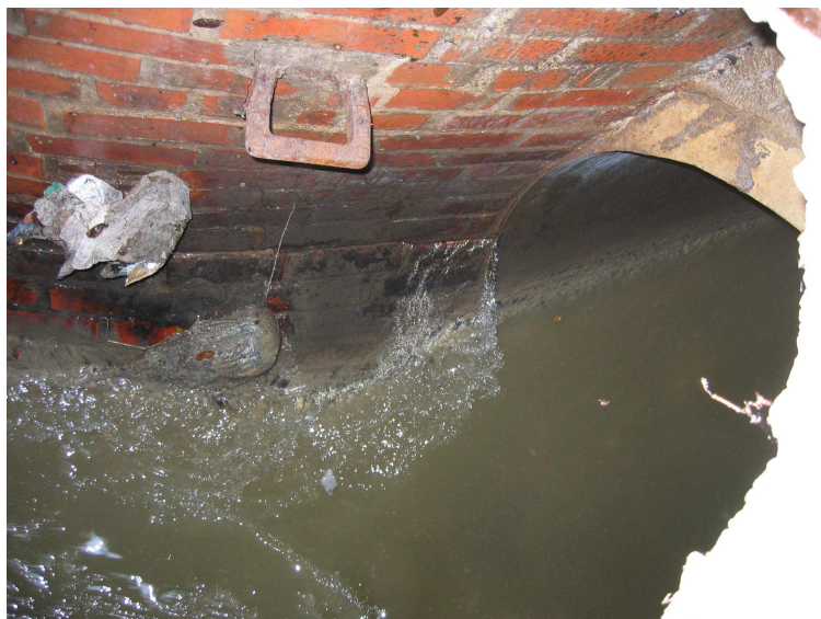
Bild 52: Undichte Schachtanbindung und Wassereintritt durch Fugen in Schacht 53760 (176)
