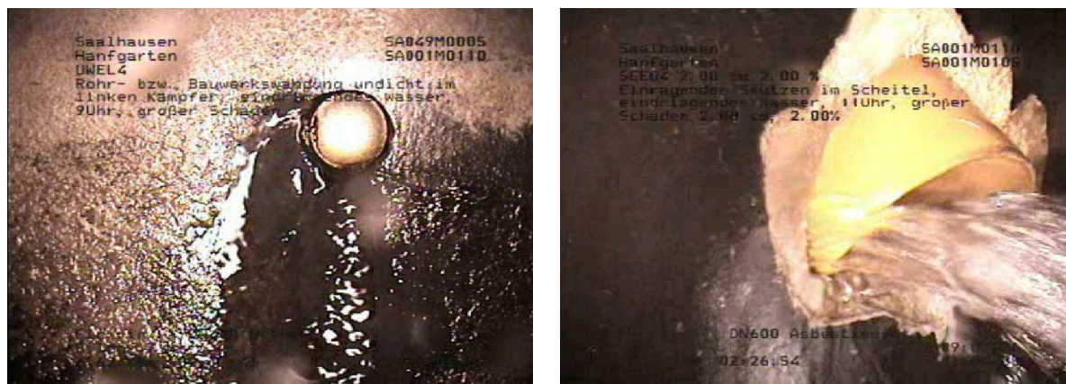
Bild 101: Links: eindringendes Wasser an den verschraubten Hausanschlüssen (Haltung SA049M0005); rechts: eindringendes Wasser durch nicht fachgerecht eingebauten Stützen in der Haltung SA001M105 im Hanfgarten in Saalhausen (242)
