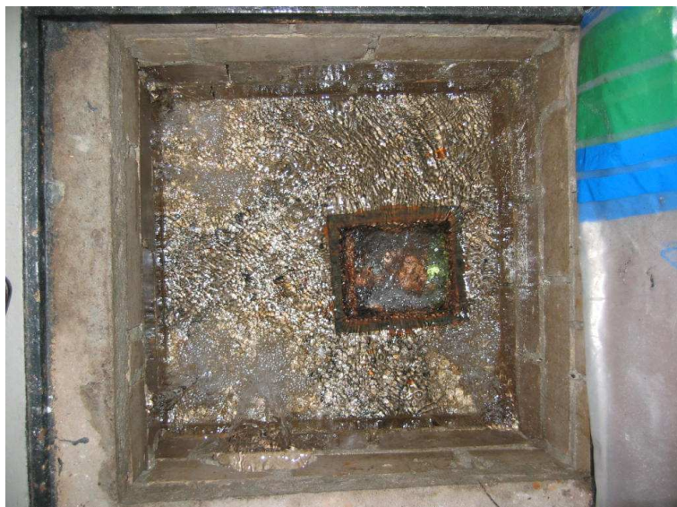
Bild 54: Eindringendes Grundwasser in den Revisionschacht des Hauses „Auf dem Schilk 1“ (176)
