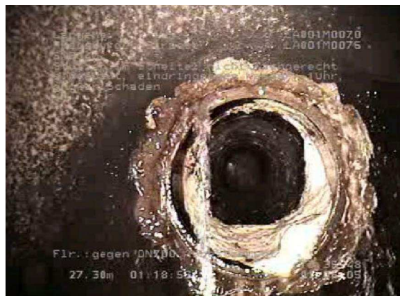
Bild 102: Eindringendes Wasser durch nicht fachgerecht eingebauten Stutzen in der Haltung LA001M0070 in der Fredeburger Straße (242)
