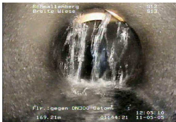
Bild 99: Eindringendes Wasser durch nicht fachgerecht eingebaute Stutzen in der Haltung S12 in Niederfleckenberg (242)
