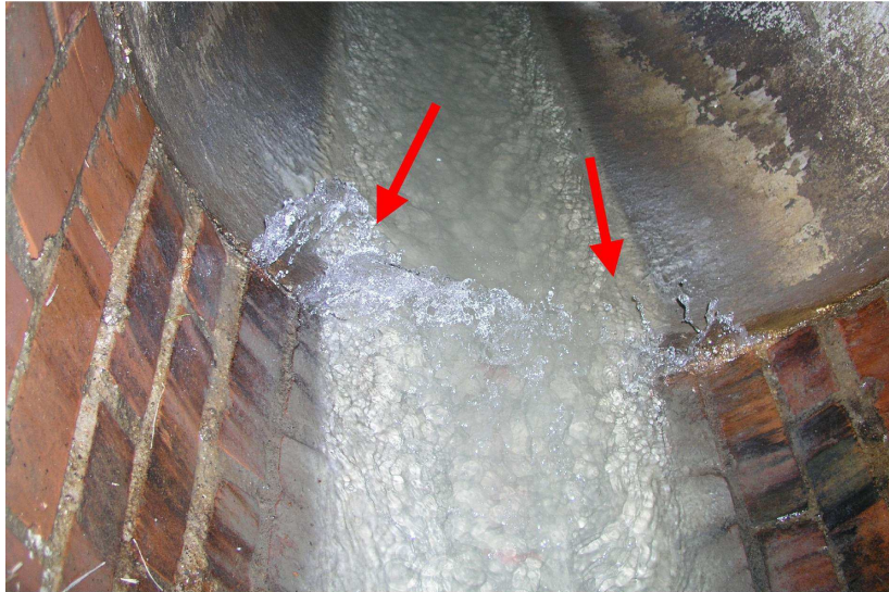
Bild 128: Fremdwassereintritt im Bereich der Rohreinbindung (253)
