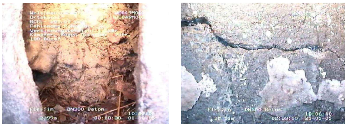
Bild 104: Links: fehlendes Rohrstück im Verbindungsbereich in der Haltung WE049M0030; rechts: 2 mm starker Längsriss im linken Kämpfer in der Haltung WE021M0035 in Welschen-Ennest West (Olpetal) (242)
