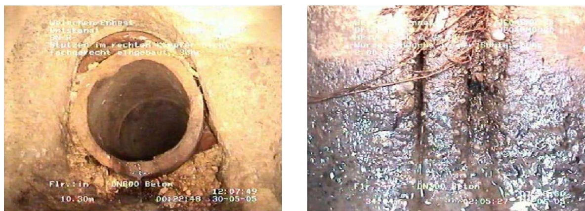
Bild 105: Festgestellte Schäden Welschen-Ennest West (Olpetal) (242), links: nicht fachgerecht eingebaute Stützen in der Haltung WE002M0085; rechts: Wurzeleinwuchs in der Sohle in der Haltung WE0480M0025
