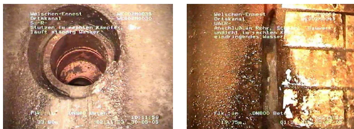
Bild 103: Links: Stutzen im rechten Kämpfer mit ständigem Wasseraustritt (Haltung WE002M0035); rechts: eindringendes Wasser durch undichten Schachtanschluss (Haltung WE002M0050) in Welschen-Ennest Ost (Olpetal) (242)
