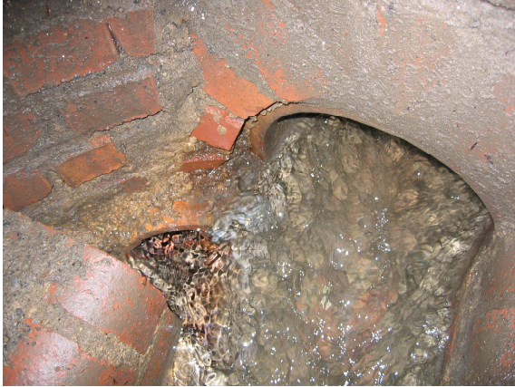
Bild 72: Fremdwasserzufluss aus vermuteten Baudränagen (Schacht 0200636) (307)
