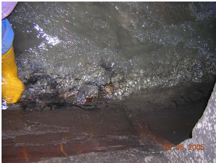
Bild 51: Betonkorrosion an der Sohle des Schachtes 74432 (176)
