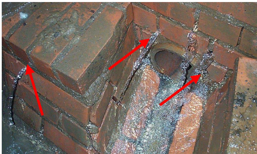
Bild 127: Undichte Rohreinbindung und undichter Schacht (253)
