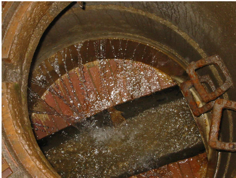
Bild 31: Fehlende Schachtringdichtung im Schacht an der Straße „Caller Bach“ (128)
