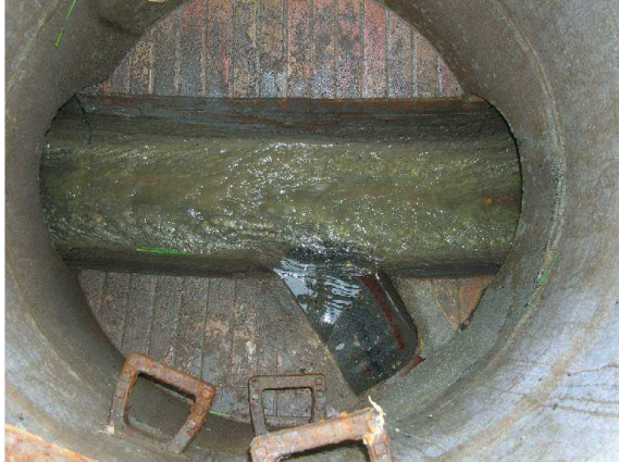
Bild 106: Hoher Fremdwasseranteil in dem Seitenzulauf des Schachtes HD002M0010 in Heidschott (Olpetal) (242)
