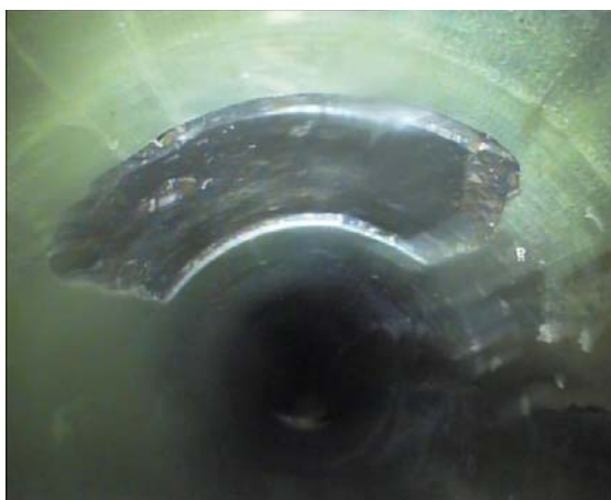
e) Ansicht der Entnahmestelle vor der Reparatur
