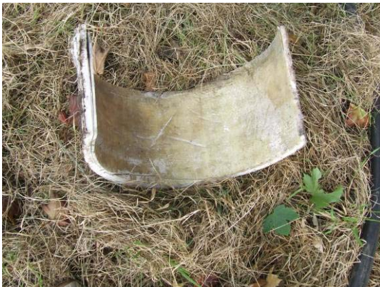
c) Ansicht einer Materialprobe nach der Entnahme aus der Haltung
