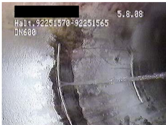
e) Infiltration von Grundwasser nach Fräsung der ersten Schnitte in Querrichtung
