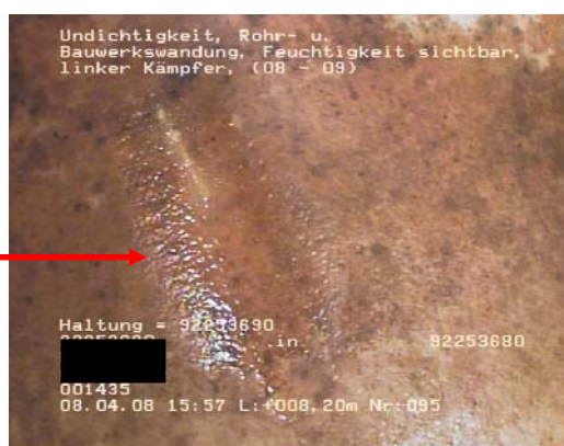
b) Feuchtigkeit im linken Kämpfer, Detailansicht
