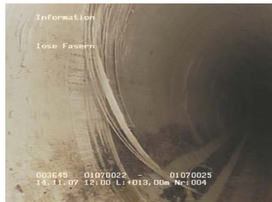
d) Ablösungen der Faserschicht, Ansicht 4
