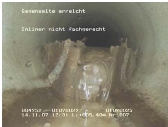
c) Ablösungen der Faserschicht, Ansicht 3
