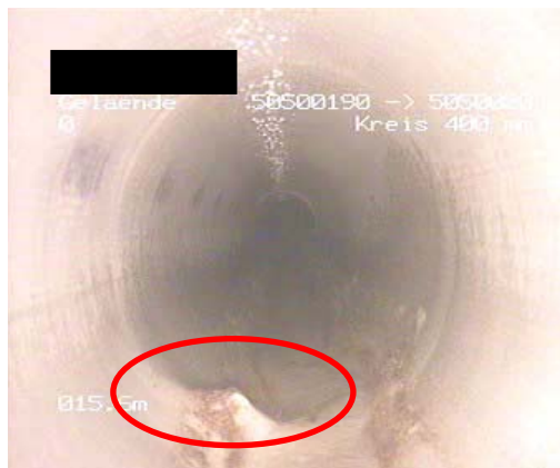
a) Lokale Beule im Sohlbereich
