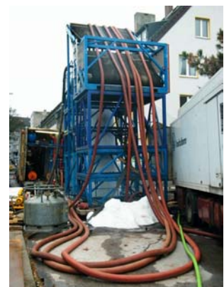
i) Mobile Heizanlage mit Heizschläuchen
