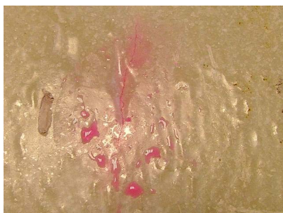
c) Außenseite des Probekörpers, Detailansicht der undichten Stelle (Haarriss)
