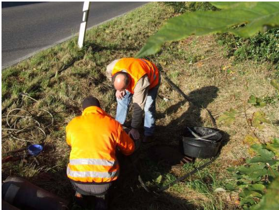
a) Begutachtung der Entnahmestelle durch den Netzbetreiber
