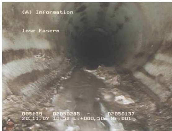
a) Ablösungen der Faserschicht, Ansicht 1
