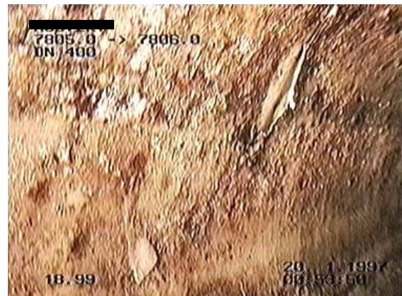
b) Ablösung der Innenbeschichtung im linken Kämpfer, Detailansicht
