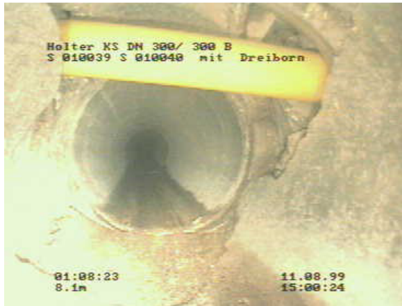
Abbildung 3: Gasleitung hat Abwasserkanal durchstoßen und verursacht fremdwas-serrelevante Schäden bei der öffentlichen Kanalisation
