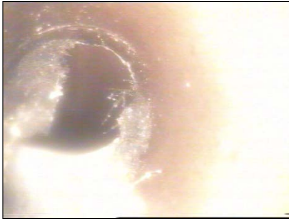
Abb. 58: Blick in die Hausanschlussleitung nach der Wurzelentfernung. Die Wurzeln wachsen durch die erste Rohrverbindung zwischen Abzweig und Hausanschlussleitung ein.
