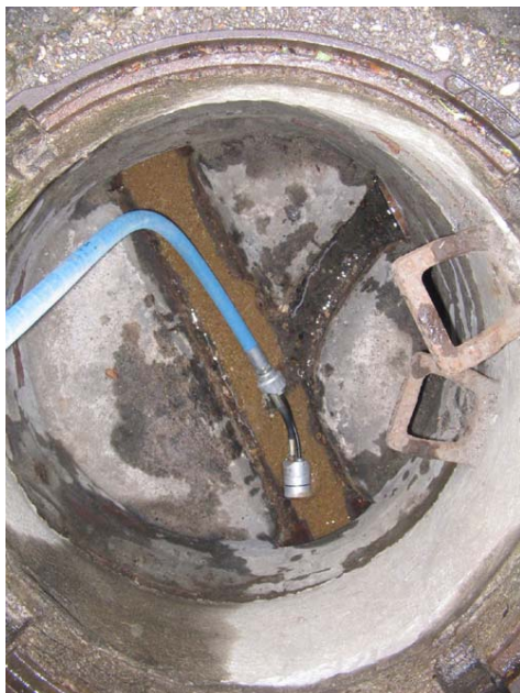
Abb. 11: Aaligator im Schacht
