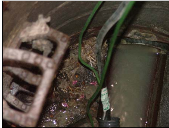
Abb. 34: Wurzeleinwuchs in einem Schacht. Die Wurzeln wachsen höchstwahrscheinlich durch die gemauerten Schachtböden ein. (vgl. auch Abb. 35)
