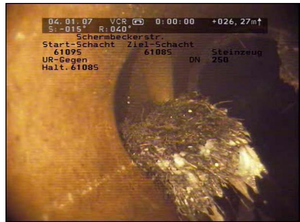
Abb. 36: Wurzeinwuchs durch einen seitlichen Zulauf. Die Wurzeln haben in der angeschlossenen Leitung ein Polster gebildet, das in den Hauptkanal hereinragt und dort ein Abflusshindernis bildet. (Haltung 6109S - 6108S, 26,27 m).
