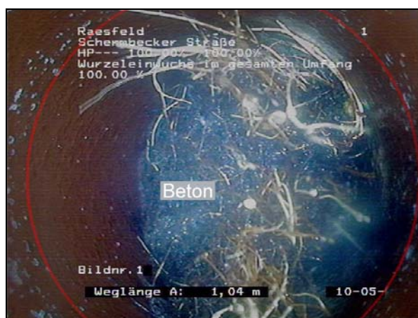
Abb. 72: Grundstücksentwässerungsleitung mit Beton verschlossen. Wurzeleinwuchs wurde mit Hilfe einer Kettenschleuder beseitigt. Die Wurzelfernung hat Veränderungen am Rohrmaterial erzeugt (rot markiert).
