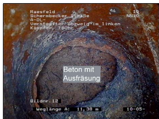
Abb. 73: Verschluss einer Grundstücksentwässerungsleitung mit Beton. Der Beton wurde mithilfe einer Kettenschleuder mit frontalem Bohrer aufgefräst. (vgl. Abb. 71)
