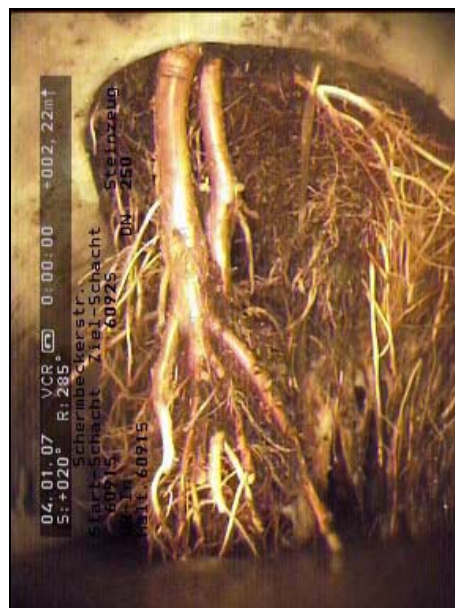
Abb. 33: Wurzeleinwuchs durch einen seitlich Zulauf. Die einwachsenden, bis zu daumendicken Wurzeln verhindern die weitergehende Inspektion des Hauptkanals DN 250.
