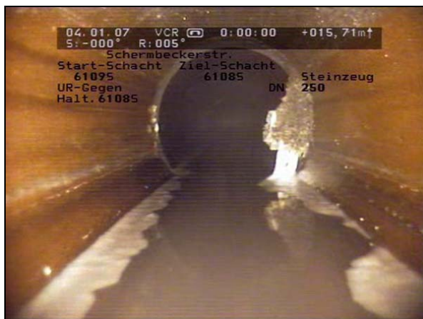
Abb. 37: Wurzeinwuchs durch eine Rohrverbindung des Hauptkanals. Die Wurzeln haben ein Polster gebildet, das im Hauptkanal ein Abflusshindernis bildet. (Haltung 6109S - 61080S, 15,71 m).
