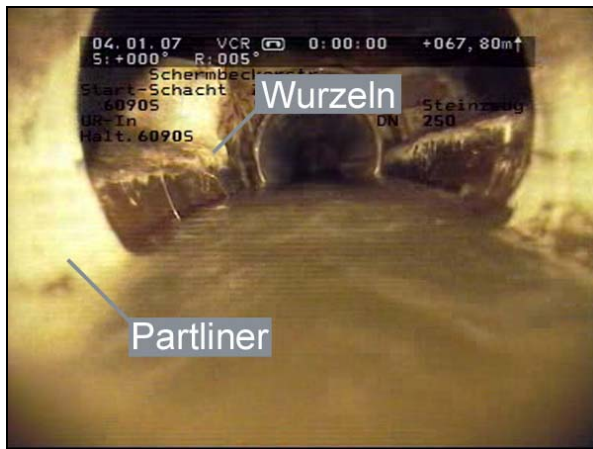
Abb. 35: Wurzeinwuchs im Schacht des Hauptkanals. Im Bereich der Berme sind Wurzeln zu erkennen. (Haltung 6090S – 6091S, 67,8 m).
