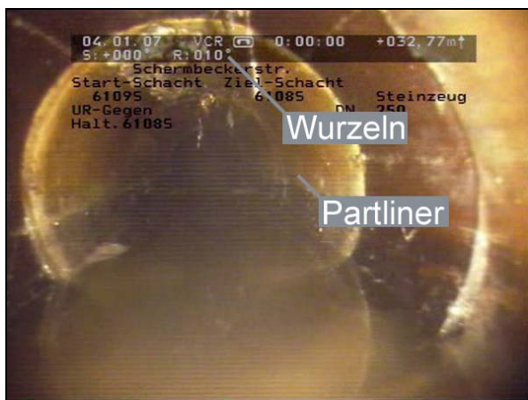
Abb. 39: Wurzeln am Rand eines Kurzschlauchs im Hauptkanal. (Haltung 6109S – 6108S, 32,77 m).
