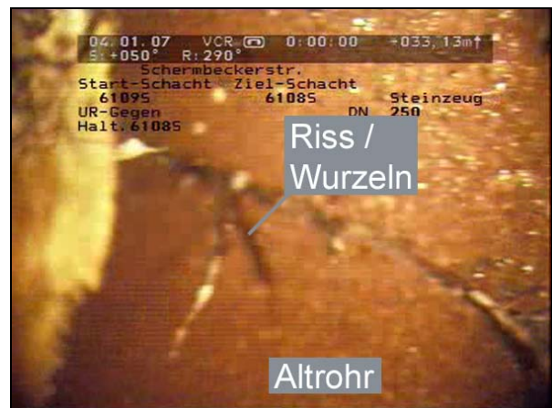
Abb. 38: Wurzeinwuchs in einem Riss im Hauptkanal (Haltung 6109S – 6108A, 33,13 m). Einzelne Wurzeln sind durch den Spalt zwischen den Scherben des Steinzeugrohrs eingewachsen.
