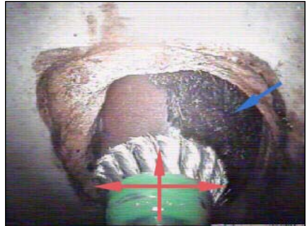
Abb. 52: Beseitigung von Wurzeinwuchs mit Hilfe einer Topfbürste. Durch die Schneidrichtung des Werkzeugs (rot gekennzeichnet) ist ein Erreichen der Wurzelpolster innerhalb der Anschlussleitung (blauer Pfeil) nur eingeschränkt möglich.
