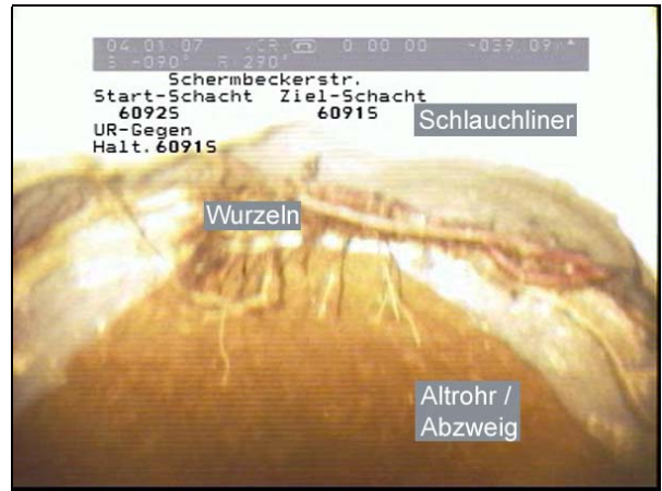
Abb. 61: Einmündungsbereich einer Grundstücksentwässerungsleitung. An der Grenze zwischen Schlauchliner und einmündender Leitung befinden sich Wurzeln, die den Querschnitt der einmündenden Leitung vermindern.
