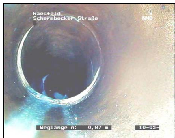
Abb. 83: Versatz in einer alten Grundstücksentwässerungsleitung.
