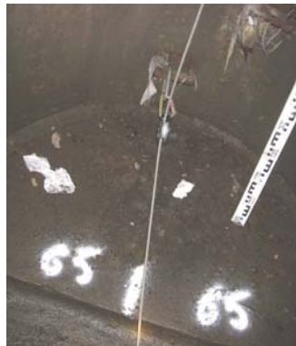
b) Umlenkrolle für Datenkabel im Einstiegsschacht
