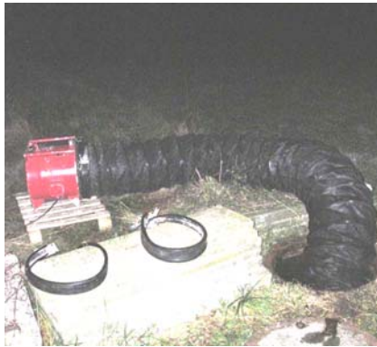
a) Belüftungsgerät für den Untersuchungsabschnitt
