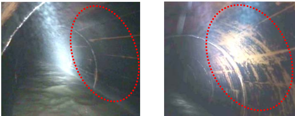
Abb. 53: Vergleich der Ablagerungssituation vor (links) und nach (rechts) dem Einsatz der Propellerdüse, Fotos: [100]*
