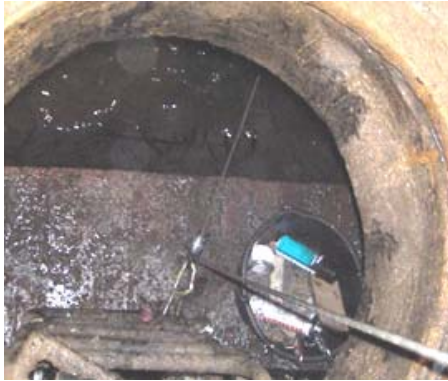
c) Umlenkrolle für Datenkabel im Einstiegsschacht
