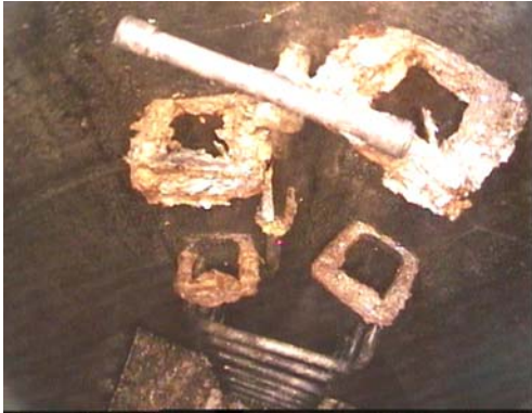
a) Korrosion an Steigeisen
