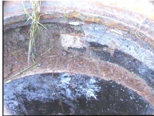
b) Schachtrahmen locker
