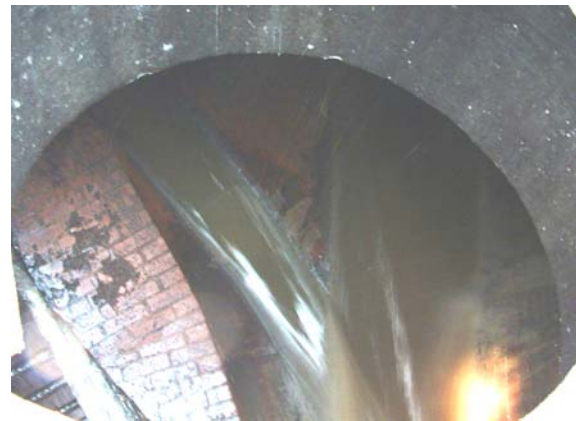
b) Beispiel 2 (Schacht 7309 0012): Einmündungsbereich eines Zulaufes, starke Strömung
