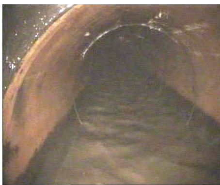
a) Beispiel 1: keine Ablagerungen
