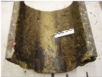
Abb. 32: unteres Kreissegment eines ausgebauten abwasserberührten Kanals einer Oberflächenschädigung durch Sulfatreiben
