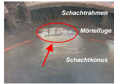
Abb. 101: Haarrisse im Mörtel
