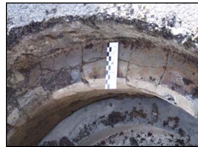
Abb. 46: Freigelegte Mörtelfuge mit Rissen
