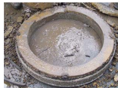
Abb. 70: Mörtelfuge mit darunter liegendem Ausgleichsring
