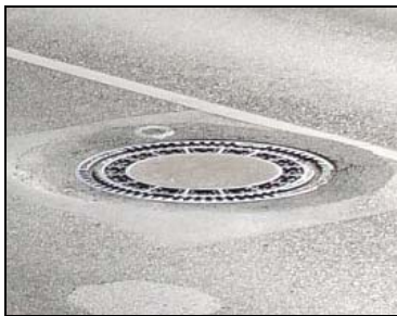
Abb. 41: Einbindung - Setzungen des Schachtes und der Fahrbahn
