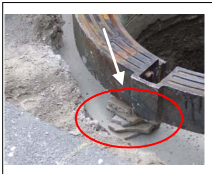
Abb. 108: unsachgemäße Unterfütterung einer Schachtabdeckung
