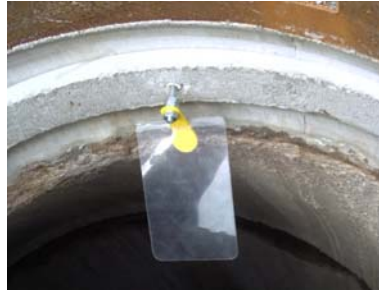
Abb. 63: Messfühler mit Abdeckung
