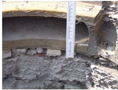
Abb. 48: Zersetzungserrscheinungen bzw. Ausbruchsstellen im Bereich der Mörtelfuge
