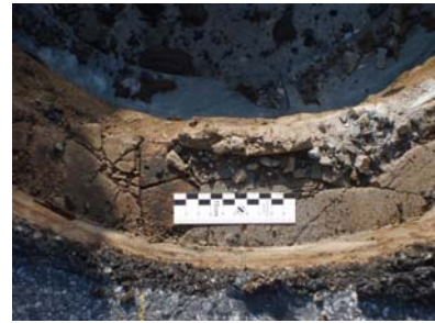
Abb. 49: Schollenbildung erkennbar nach Freilegung der Mörtelfuge
