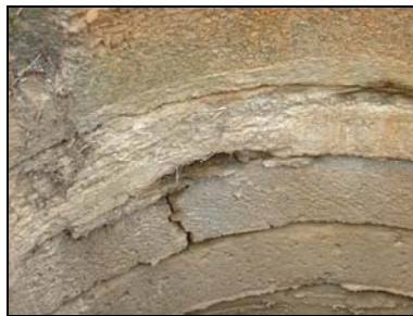
Abb. 42: Schachtkopf: Ausgleichsring gerissen
