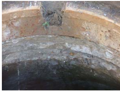
Abb. 47: Absandungen im Bereich der Mörtelfuge
