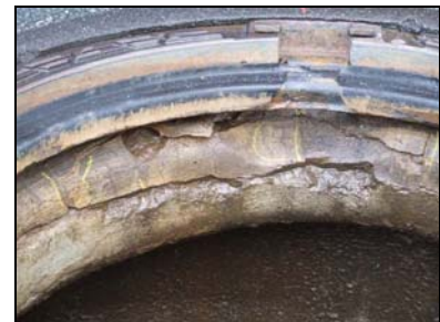
Abb. 43: Mörtelfuge - Risse und Ausbruchsstellen im Mörtel
