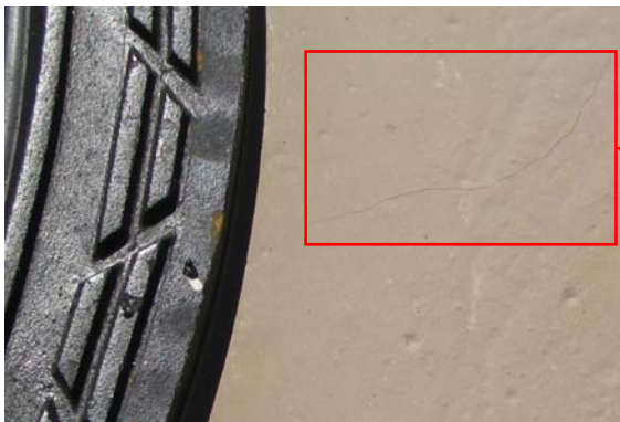
Abb. 111: Rissbildung unmittelbar nach Verguss
