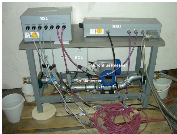
Abbildung 7.11: BSU, MSU, BCU und Durchflussmesser der Fa. Centerline GmbH, Wesel
