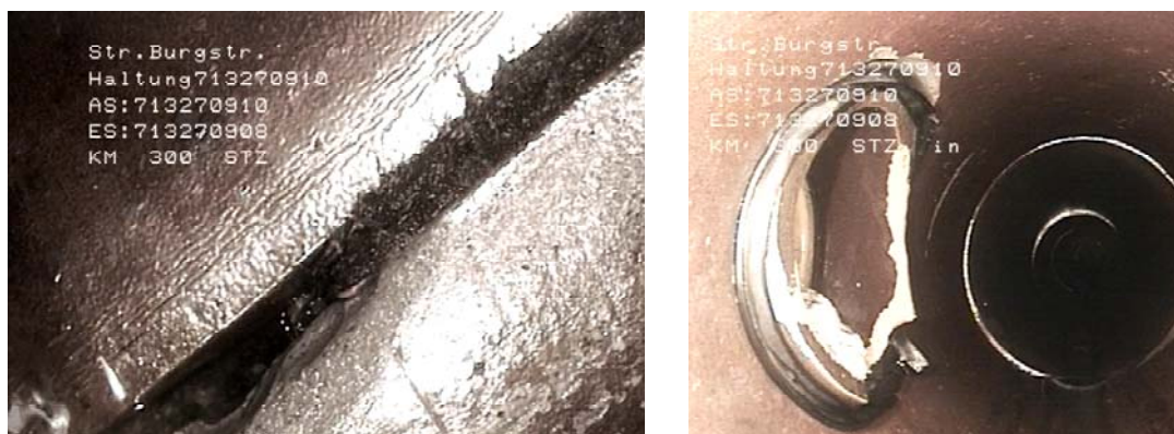
Abbildung 6-1: Steinzeughaltung DN 300 mit Wurzeleinwuchs (links) und einragenden Stützen (rechts)
