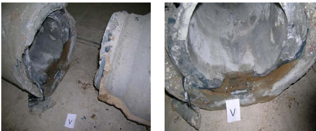
Abbildung 5-21: Sanierte Betonrohrverbindung mit Sandablagerungen in der Sole des Muffenspalts
