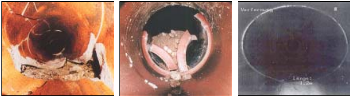
Abbildung 43: Rohrbruch, Einsturz und Verformung [38], [22]
