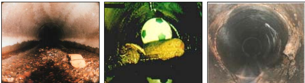
Abbildung 34: Ablagerungen, Abflusshindernisse und Inkrustationen [38], [22]
