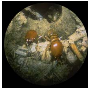
Abbildung 98: Endoskopische Untersuchung bei einem Termitenbefall in einer Holzkonstruktion [115]
