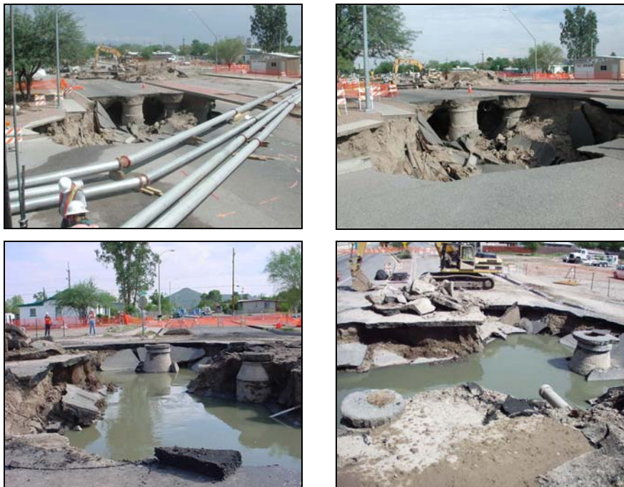
Abbildung 7: Tagesbruch in Tucson, Arizona am 7.11.2002 [16]
