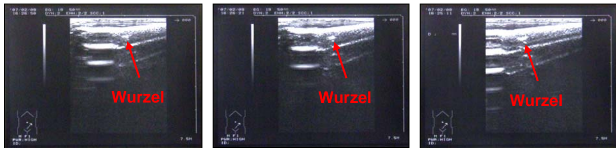
Abbildung 73: Ergebnis der Ultraschalluntersuchung einer Rohrverbindung mit Wurzeinwuchs [22]
