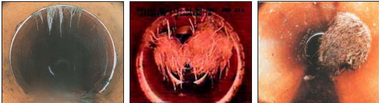
Abbildung 46: Wurzeleinwuchs in den Kanal [38]
