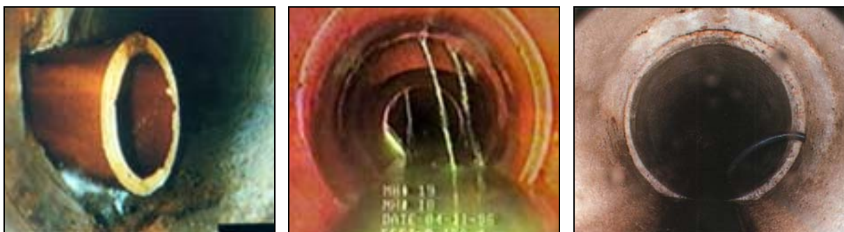
Abbildung 45: Schadhafter Anschluss, undichte Rohrverbindung und einragende Dichtungen [38], [22]
