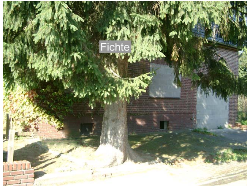
Abb. 44: Vorderansicht des Untersuchungsobjekts 8. In 2,6 m Entfernung zur Fichte verläuft eine Entwässerungsleitung Richtung Straße (Leitung nicht im Bild).
