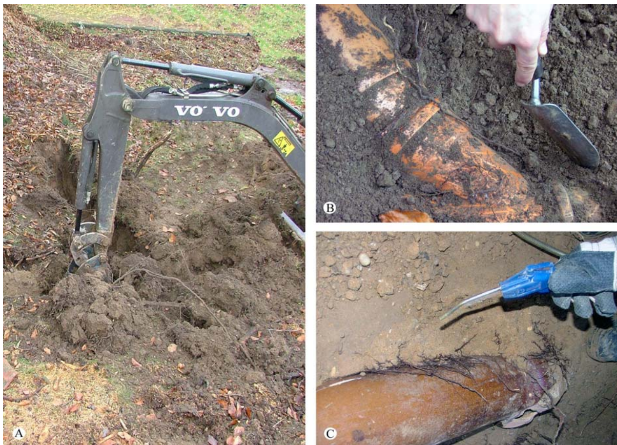
Abb. 10: Aufgrabungstechniken. A Aufgraben der Oberfläche und Aushub mit dem Bagger; B Freilegen des Leitungsbereichs von Hand; C Säubern der Wurzeln und der Leitungsoberfläche mit Druckluft.
