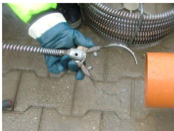
Abb. 53: Mechanischer Wurzelschneider zur Beseitigung von Wurzelschäden.
