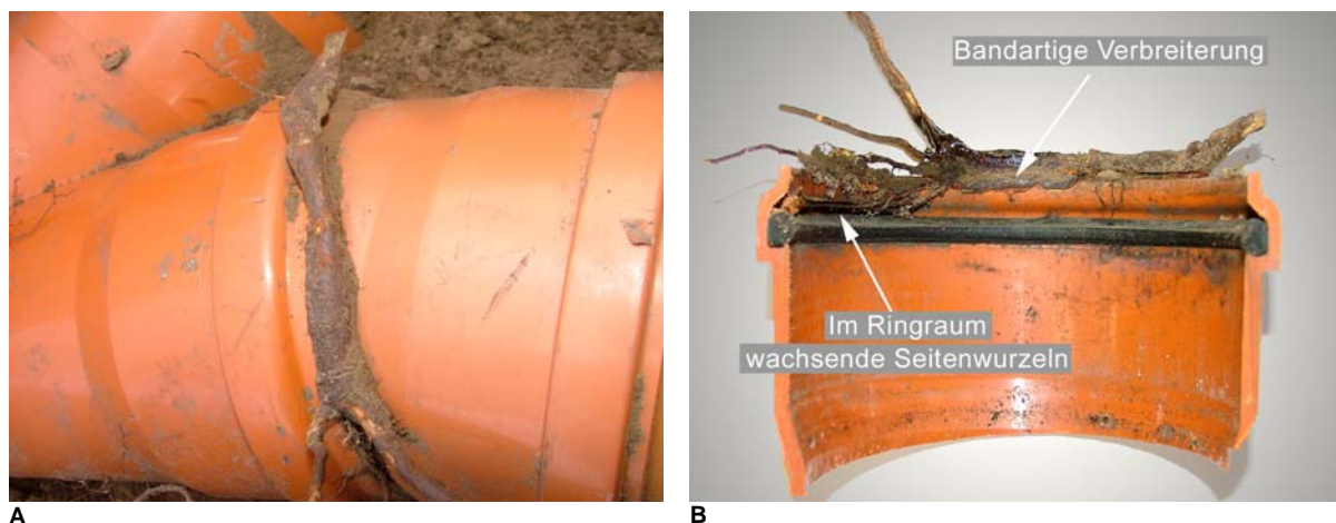
Abb. 17: Eine Wurzel umwächst eine Rohrverbindung. A Die Wurzel liegt auf dem Ringspalt der Rohrverbindung. B Nach Öffnen der Rohrverbindung: Die Wurzel hat sich verzweigt, zum Teil bandartig verbreitert und sich in Richtung des Dichtelementes ausgebreitet, nachdem sie den Ringspalt ausgefüllt hat. Sie hat jedoch nicht die Dichtlippe überwunden und ist nicht in den Querschnitt der Leitung gewachsen.
