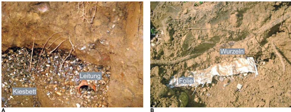
Abb. 39: Objekt 6. A Untersuchungsstelle A: Im locker verfüllten Bereich oberhalb der Rigole wachsen zahlreiche Wurzeln. Im Kiesbett unterhalb der Folie haben sich keine Wurzeln ausgebreitet. B Untersuchungsstelle B: Oberhalb der Kunststoffolie ist der Boden von Wurzeln durchzogen.
