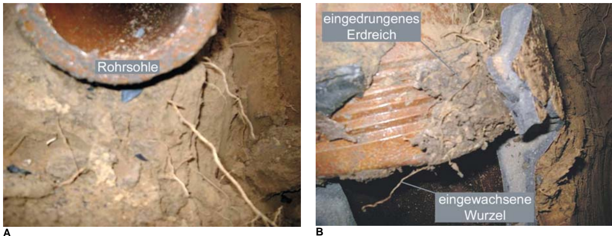
Abb. 32: Untersuchungsstelle A: A Im Bereich der Rohrsohle befinden sich Wurzeln und wachsen parallel zum Leitungsverlauf. B Geöffnete Rohrverbindung: In die von Vergussmasse freien Bereiche des Ringspalts sind Erdreich und Wurzeln eingedrungen. Wurzeln ragen in den Leitungsquerschnitt.
