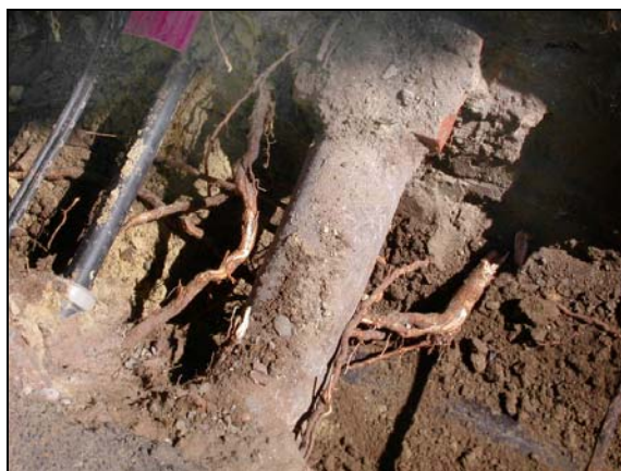
Abb. 7: Wurzeln haben sich im Bettungsmaterial von Versorgungsleitungen ausgebreitet.
