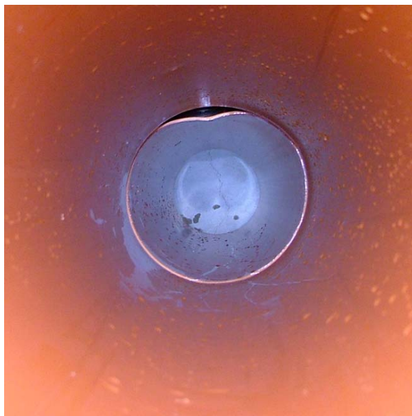
Abb.64: Rohrverbindung Wavin KG PVC nach einem Außenüberdruck von 3,89 bar. Wassereintritt durch Verformung des Spitzendes.
