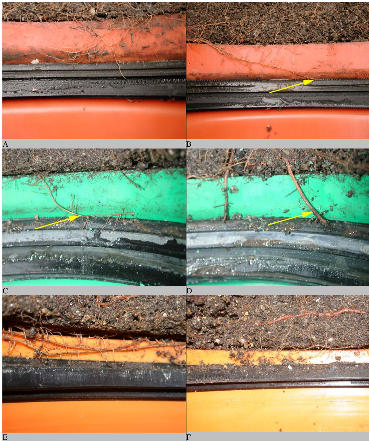
Abb. 96: Auswertung der Outside-In-Versuche A Rehau PVC SN 8 - Variation 1. B Rehau PVC SN 8 - Variation 2. Die Wurzeln befinden sich in direkter Nähe zum Dichtelement (Pfeil). C Ostendorf KG 2000 PP - Variation 1. Wurzeln befinden sich unterhalb des Dichtelementes (Pfeil). D Ostendorf KG 2000 PP. Die Wurzeln befinden sich in direkter Nähe zum Dichtelement (Pfeil). E Rausisto SN 10 PP - Variation 1. F Rausisto SN 10 PP - Variation 2.
