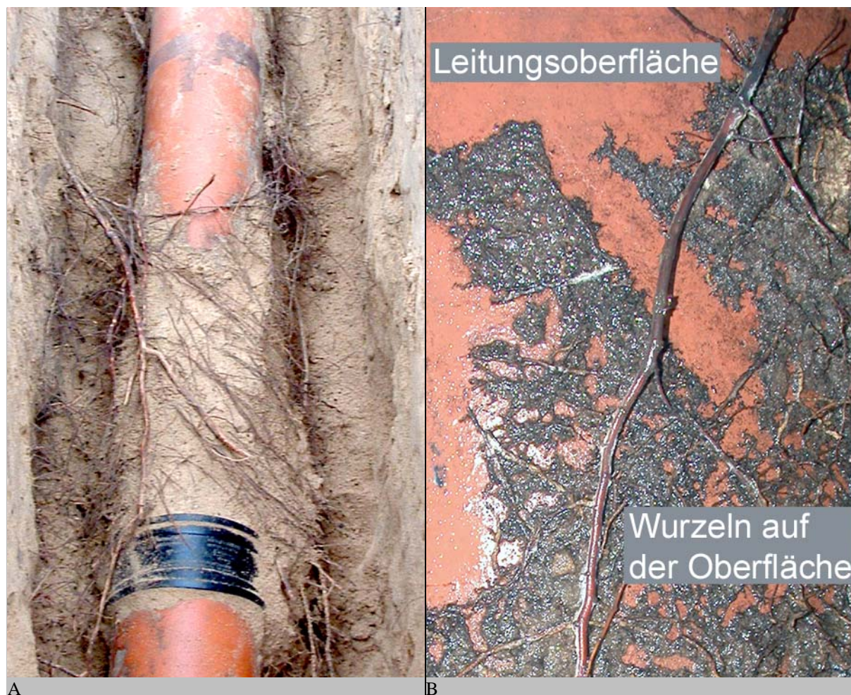
Abb. 135: In einigen Fällen geht von der Oberfläche einer Leitung ein so starker Reiz aus, dass Wurzeln in direktem Kontakt zur Leitungsoberfläche wachsen A: Das Beispiel zeigt eine unglasierte Steinzeugleitung mit Überschiebkupplungen. Aus den umgebenden Bodenbereichen sind einige Baumwurzeln in das Bettungs- bzw. Verfüllmaterial der Abwasserleitung gewachsen und befinden sich im Bereich des Scheitels eng anliegend auf der Leitungsoberfläche. B Wurzeln haben im direkten Kontakt mit der äußeren Leitungsoberfläche der unglasierten Leitung ihr Wachstum fortgesetzt.
