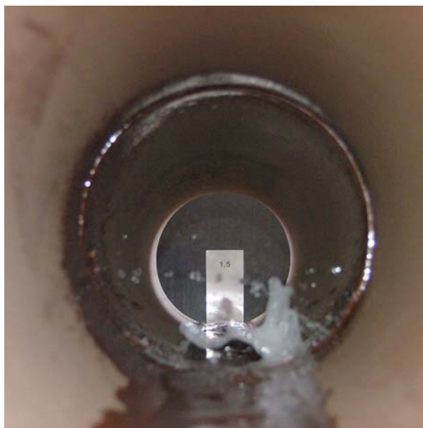
Abb.49: Rohrverbindung Euroceramic Eurotop DN 150. Angestrebte Druckstufe 1,5 bar. Hier Wassereintritt bei einem Außenüberdruck von ca. 1,2 bar. Versagen des Dichtelementes.
