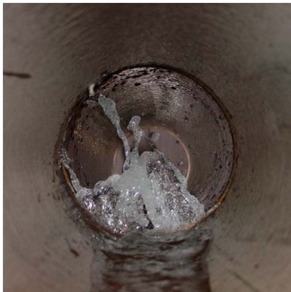
Abb.42: Rohrverbindung Steinzeug Cerafix DN 150. Angestrebte Druckstufe 1,5 bar. Hier Wassereintritt bei einem Außenüberdruck von ca. 1,4 bar. (vgl. Tabelle 6 ).
