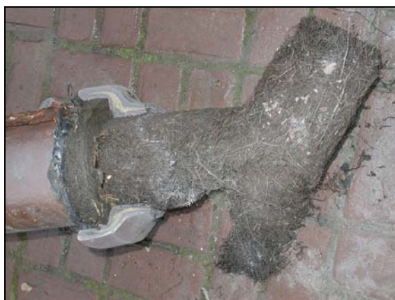
Abb. 10: Wurzelpolster im Abzweig einer Regenwasserleitung. Der Abzweig wurde teilweise entfernt. Die Wurzeln bilden ein dichtes Polster auf der Sohle der Leitung, welches die Form des Abzweiges abbildet
