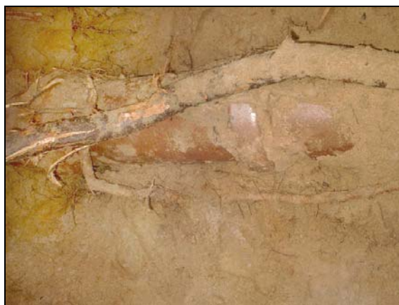
Abb. 8: Verholzte Wurzeln sind parallel zur Leitung gewachsen. Die Wurzeln haben hier einen Durchmesser von bis zu 0,2 m.
