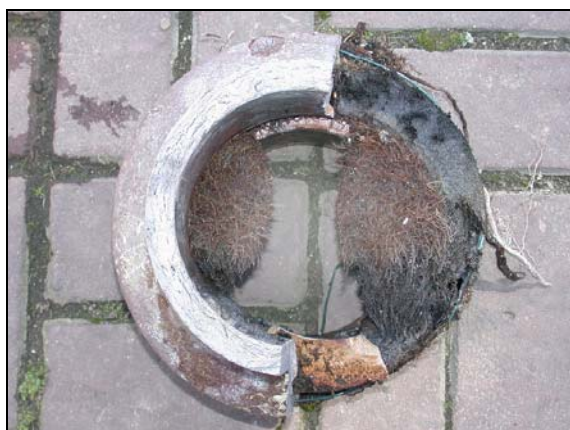
Abb. 9: Blickrichtung gegen Fließrichtung. Die Rohrverbindung wurde geöffnet und eine Hälfte entfernt. Der mittlere Wasserstand bei Betrieb der Rohrleitung wird durch den Belag in der Sohle deutlich.
