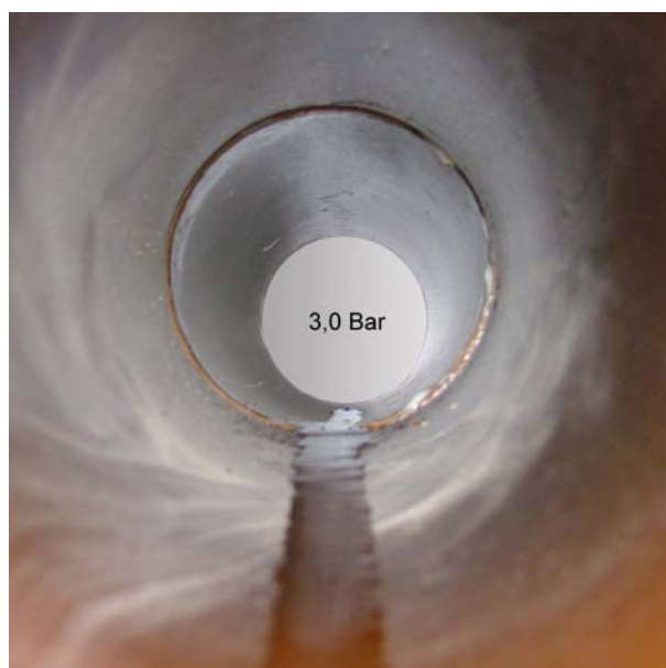
Abb.46: Rohrverbindung Euroceramic Eurotrade DN 150. Angestrebte Druckstufe 3 bar. Hier Wassereintritt bei einem Außenüberdruck von ca. 2,2 bar.
