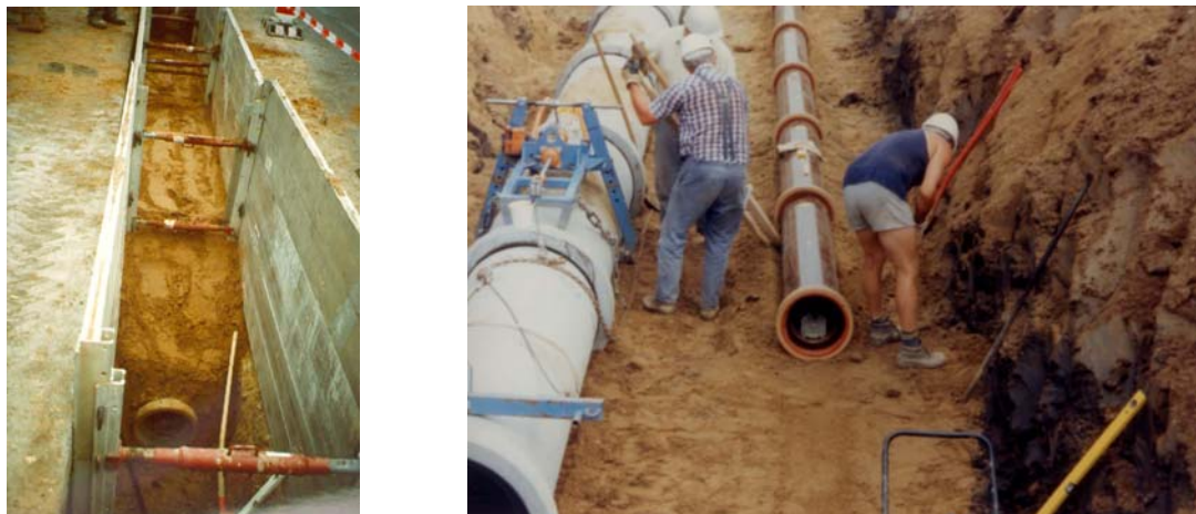
Bild 3 Darstellungen des Rohrgrabens und der Verdichtung des Zwickelbereiches in der Praxis [Güteschutz Kanalbau]
