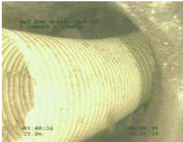
Abbildung 4-3: Unerlaubter Anschluss einer Baudränage an eine öffentliche Abwasseranlage in einem FW-Schwerpunktgebiet [KommunalAgenturNRW]
