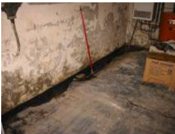
Abbildung 4-2: Beispiel Gebäudevernässung [KommunalAgenturNRW]
