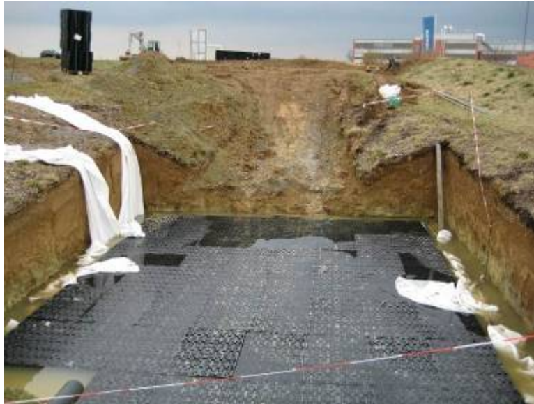
Abbildung 4-8: Versickerungsanlage bei ungeeigneten Bodenverhältnissen. Das Wasser steht fast bis zur Oberkante der Versickerungsanlage an. [Fachkundige Stelle Wasserwirtschaft (FSW) Stadt Würzburg]
