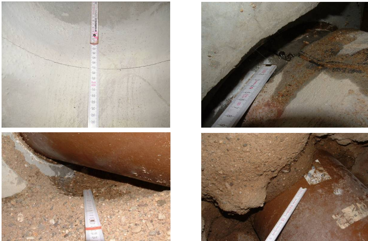
Bild 200 Beispiele für Undichtigkeiten an den Sanierungen bei der ersten Dichtheitsprüfung: Umlaufender Riss im Reparaturmörtel (oben links); Wasser-austritt an mit Epoxidharzmörtel abgedichteter Schadstelle (oben rechts); Undichtigkeit an dauerelastischer Fuge (unten links); Wasser-austritt an mit Polyurethanschaum/-harz abgedichteter Schadstelle (unten rechts)
