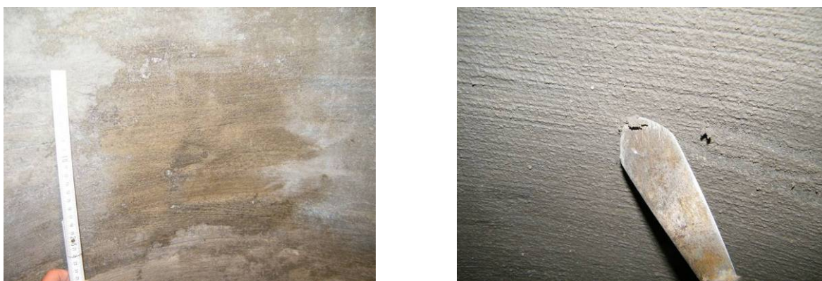
Bild 83 Dunkle Färbung der Beschichtung im Bereich einer lokalen Fehlstelle in Schachtring 3 (links), minderfestes Beschichtungsmaterial im unteren Bereich des Schachtes kann mit einem Spachtel ca. 2 mm tief abgeschabt werden (rechts)
