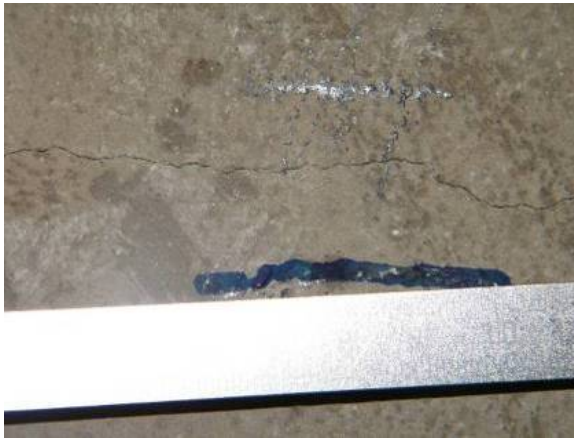
Bild 179 Riss im oberen Hohlstellengrenzbereich von Probekörper H6
