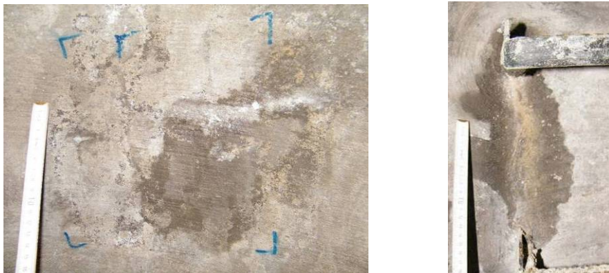
Bild 82 Feuchtigkeit auf der Beschichtung unterhalb eines Risses im Bereich einer Hohlstelle aus planmäßiger Verbundschwächung durch Trennmittel (FU 6p, links), Feuchtfahne unterhalb des linken Einbindebereichs des vierten Steigbügels (rechts)
