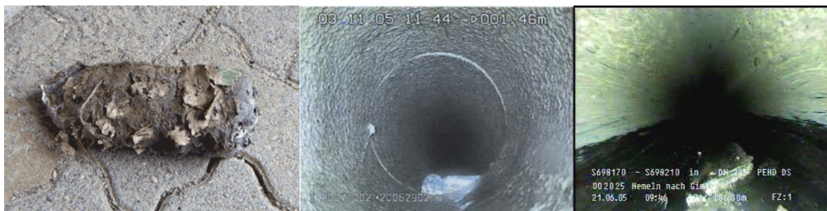
Abb. 123: Beispiele für Ablagerungen in Druckleitungen: (li) geborgene Verstopfung aus Laub, Sand, Faserstoffen, Toilettenpapier, Steinen etc [31].; (mi) verfestigtes Hindernis (evt. einragender Gegenstand); (re) Stein
