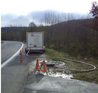
Abb. 40: Spülfahrzeug am Spül- und Entleerungsschacht
