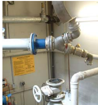
Abb. 53: Anschluss des Pumpaggregats
