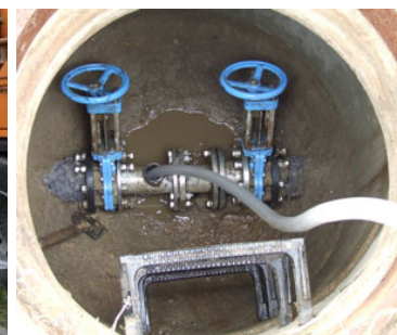
Abb. 102: Revisionschacht mit Schiebern und Spülstutzen
