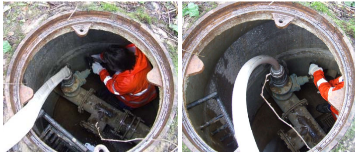
Abb. 41: Anschluss des Druckluftschlauches an die Druckleitung (ohne (li) und mit (re) Druckluftzugabe)
