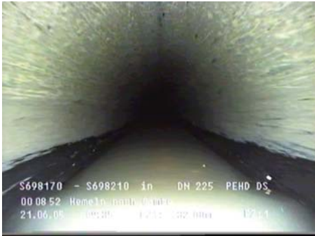
Abb. 16: Beispiel 1 – Inspektion vor der Reinigung
