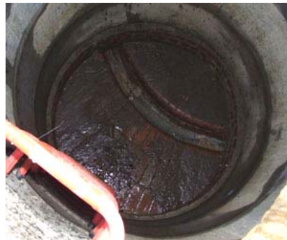
Abb. 118: Schacht mit Zulauf zur Pumpstation
