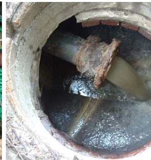
Abb. 62: Auslauf während des üblichen Abwasser-Pumpetriebs
