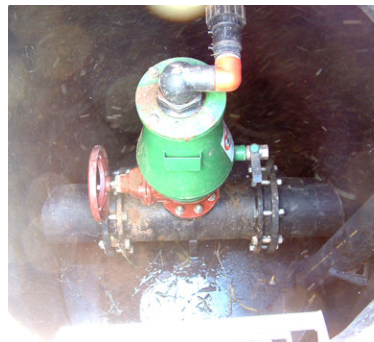
Abb. 9: Druckleitung mit Be-/Entlüftungsventil
