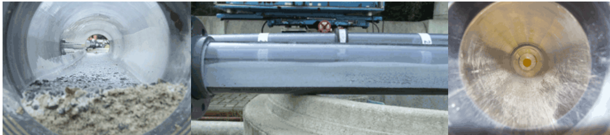
Abb. 135: Beispiel für eingebrachte Ablagerung aus Estrichbeton (li, mi); angerautes Rohr (re)
