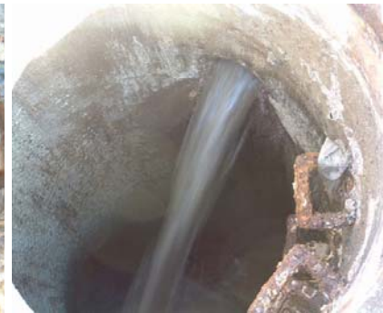
Abb. 15: Spülschwall am Auslauf der Druckleitung
