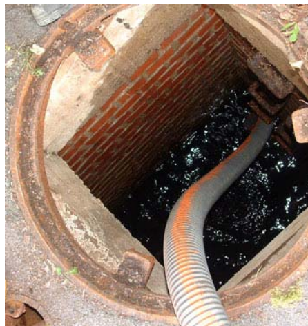
Abb. 68: Entleerungsschacht vor dem Auslauf der Druckleitung (Verbindung zur Druckleitung über Stutzen und Schieber)
