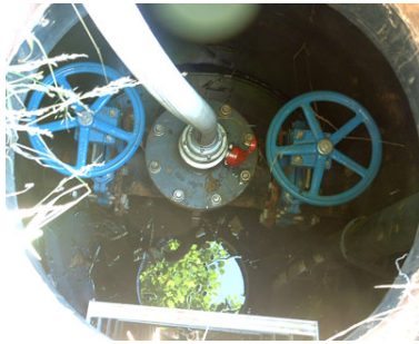
Abb. 2: Revisionszugang einer Druckleitung mit Spülstutzen und Schiebern
