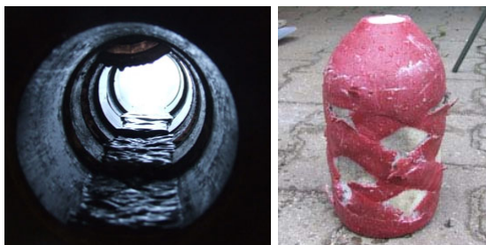
Abb. 160: Einragender Schieber (li) und beschädigter Molch (re)
