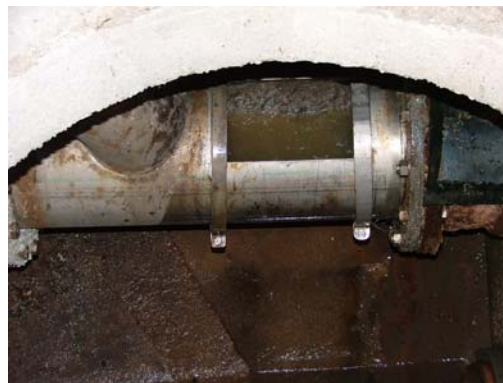
Abb. 23: Schacht „Leonard-Kraus-Straße“: Freispiegelkanal (geschlossene Rohrdurchführung) unmittelbar hinter der Anschlussstelle der Druckleitung
