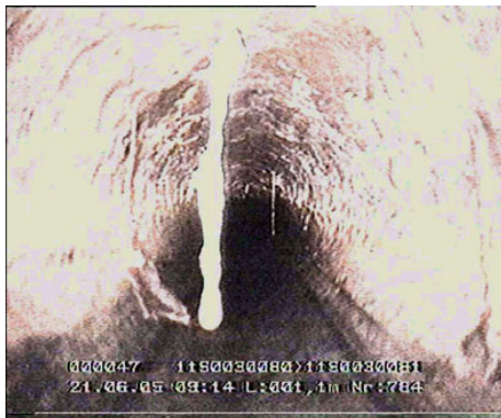
Abb. 70: Leitung vor der Reinigung
