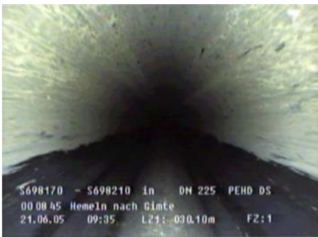
Abb. 18: Beispiel 2 – Inspektion vor der Reinigung
