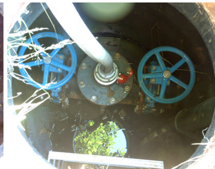
Abb. 10: Druckleitung mit zwei Schiebern und T-Flansch
