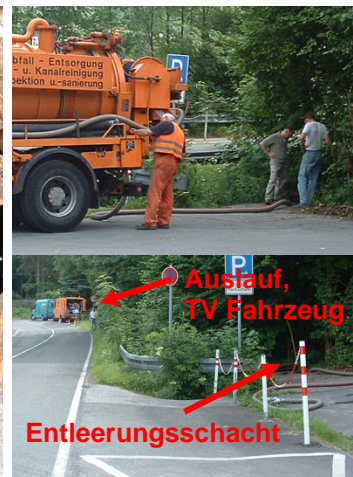
Abb. 69: Saugfahrzeug am Entleerungsschacht (o), Position Entleerungsschacht und Auslauf der Druckleitung (u)
