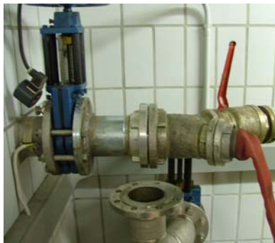
Abb. 80: Anschluss der Pumpe
