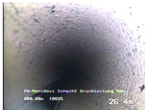
Abb. 108: Bildausschnitt – Inspektion gegen die Fließrichtung nach Zugabe von „Lipolyt 2000“
