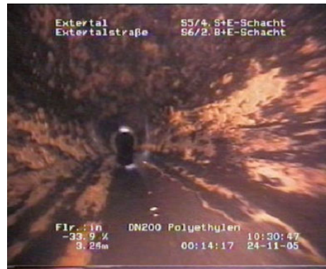
Abb. 46: Ablagerungen nach der Impuls-Spülung
