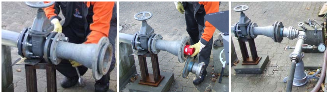
Abb. 152: Konus (li), Einsetzen eines Molche (mi), Anschluss von Manometer und Schlauch zur Tragkraftspritze (re)
