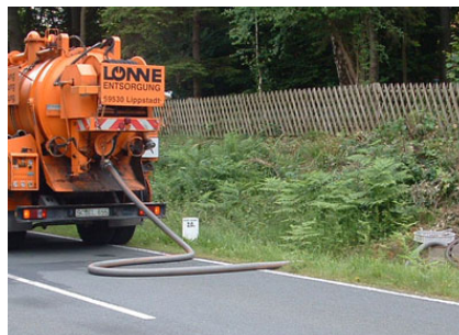
Abb. 56: Saugfahrzeug hinter dem Auslauf der Druckleitung
