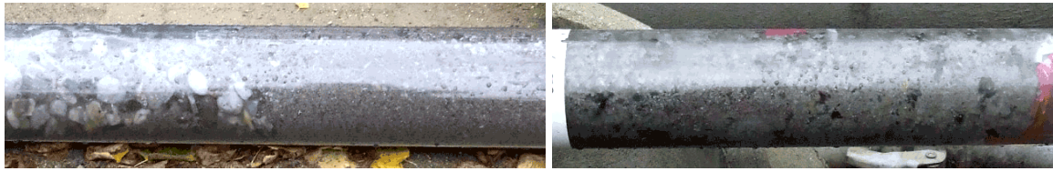
Abb. 151: Mit Wasser aufeinander gespülte Ablagerungen: Übergang von Kies auf Sand/Faser (li) und „Verstopfungsmixtur“ aus Fasern, Sand, Laub, Bentonit, Wasser etc.
