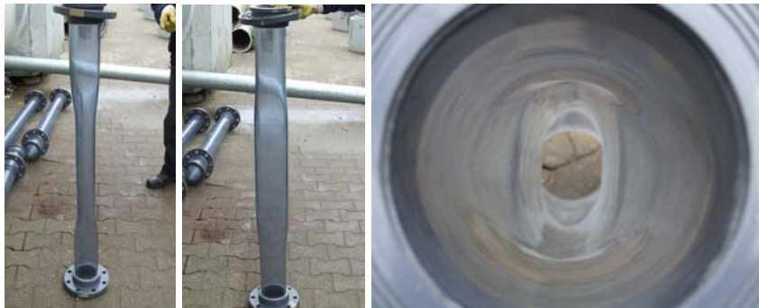
Abb. 161: Ovalisiertes Rohrstück (Verformung 40 %)
