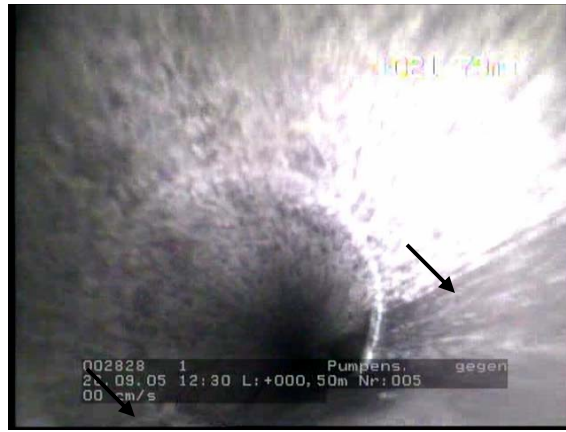
Abb. 31: Ablagerungssituation nach der Reinigung
