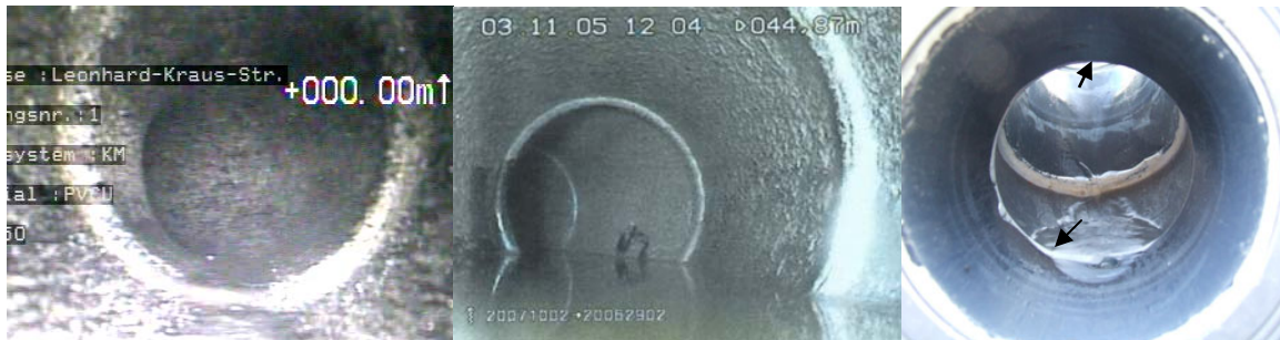
Abb. 127: 90°-Bogen einer Druckleitung PVC DN 150 (li), 45°-Bogen einer Druckleitung PE DN 150 (mi) und PVC-Winkelformstück der Teststrecke (re)
