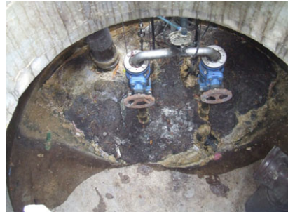
Abb. 110: Pumpenschacht nach der Impfung (Beispiel 1)
