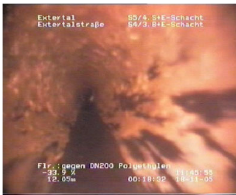
Abb. 47: Ablagerungen vor der Reinigung mittels Kanaldüse
