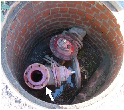
Abb. 32: Schacht mit Zugang über ein T-Stück mit Schieber
