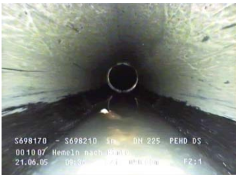
Abb. 20: Beispiel 3 – Inspektion vor der Reinigung
