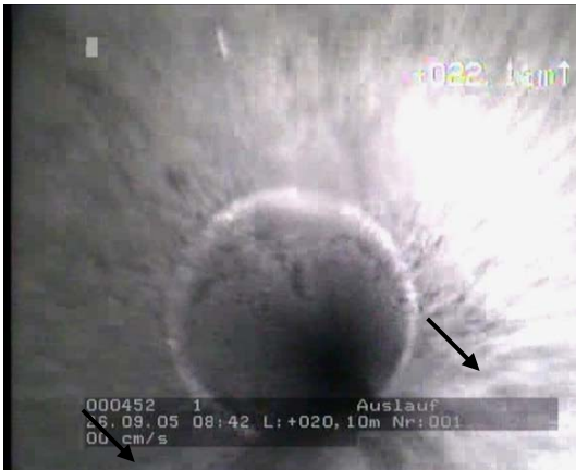
Abb. 30: Ablagerungssituation vor der Reinigung
