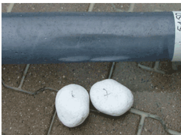
Abb. 138: Beispiel für eingebrachte Steine als Abflusshindernis
