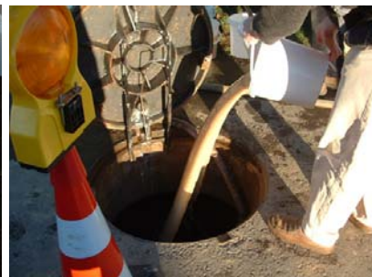
Abb. 92: Zugabe des Substrates-Wasser-Gemisches in den Pumpenschacht 1
