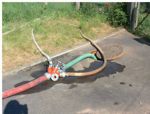
Abb. 12: Zuleitung des Flusswassers zum Pumpenschacht
