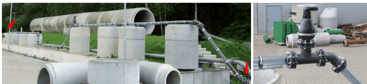
Abb. 128: Leitungsabschnitt „Extremsituation“ (li) und Detail Entlüftungsventil (re)
