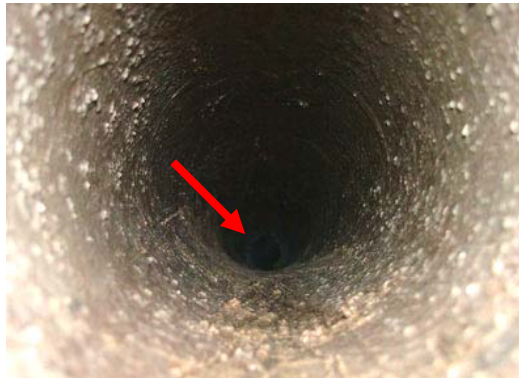
Abb. 76: Druckleitungsanfang mit einragender Dichtung
