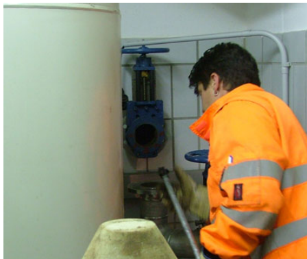
Abb. 75: Zugang zur Druckleitung in der Pumpstation
