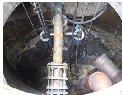
Abb. 112: Pumpenschacht nach der Impfung (Beispiel 2)
