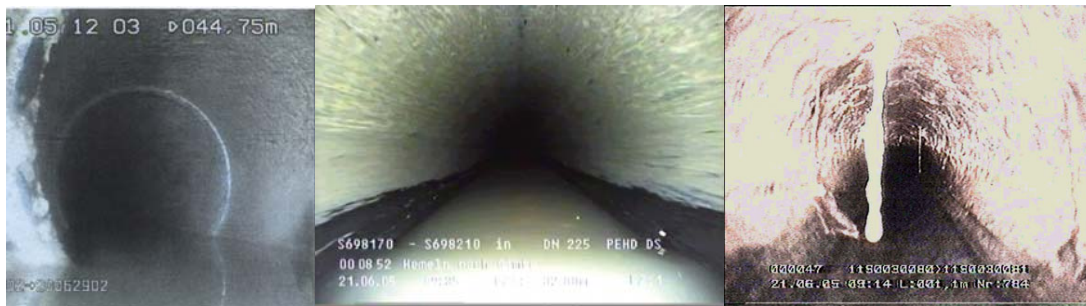
Abb. 122: Beispiele für Ablagerungen in Druckleitungen: (li) Sielhaut u. evt. Fett; (mi) vorwiegend Fett; (re) Sielhaut mit Fasern und evt. Fett
