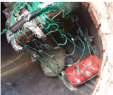
Abb. 55: Sicherungsnetz am Ende der Druckleitung
