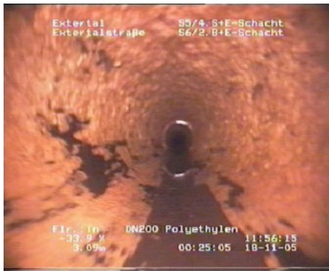
Abb. 45: Ablagerungen vor der Impuls-Spülung
