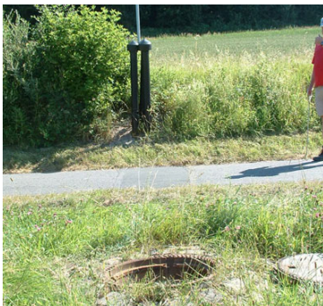
Abb. 8: Hochpunkt mit Schacht und Be-/Entlüftungsleitung
