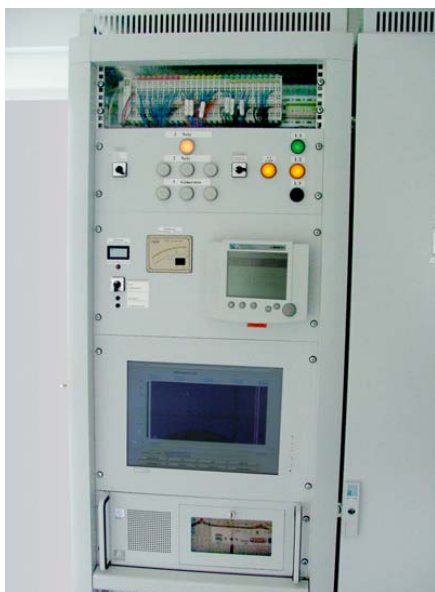
Bild 12: Messwerterfassungssystem im zentralen Rein- und Messbereich
