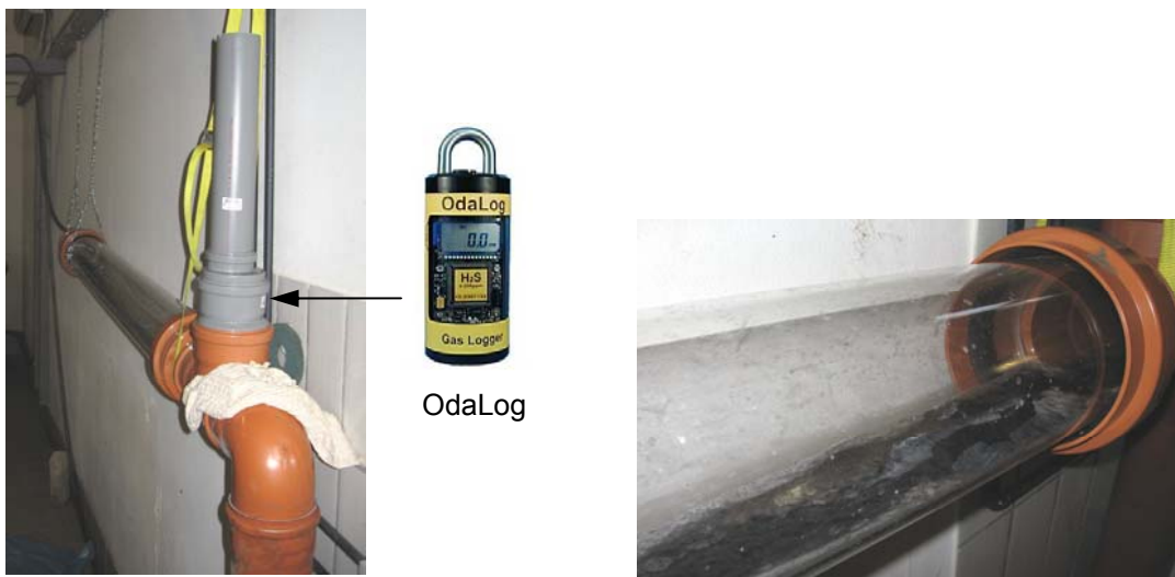
Bild 142: Versuchstand „Kanalrohr“ auf der Versuchsanlage Ölbachtal (rechts) und Ablagerungen im Rohr (links)
