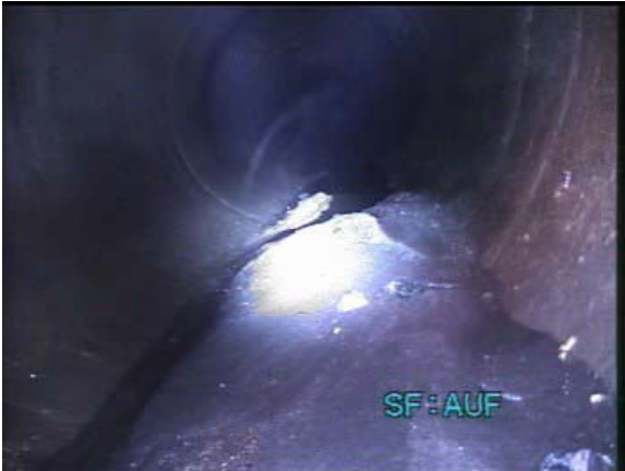
Bild 72: Ablagerungssituation vor der Reinigung
