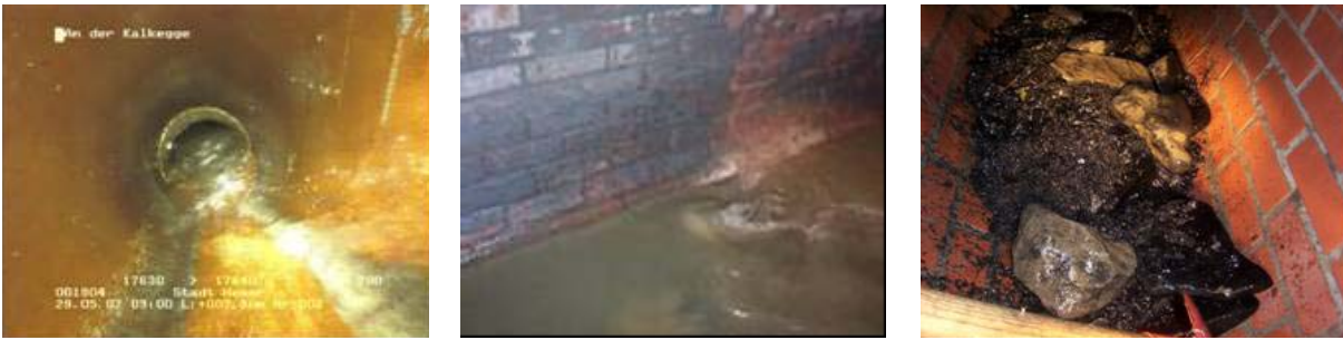
Bild 56: Beispiel rückstaugefährdeter Bereiche, links: Absturz, Mitte: Stauraumkanal eines Regenüberlaufs, rechts: Räumgut vor der Drossel im Stauraumkanal
