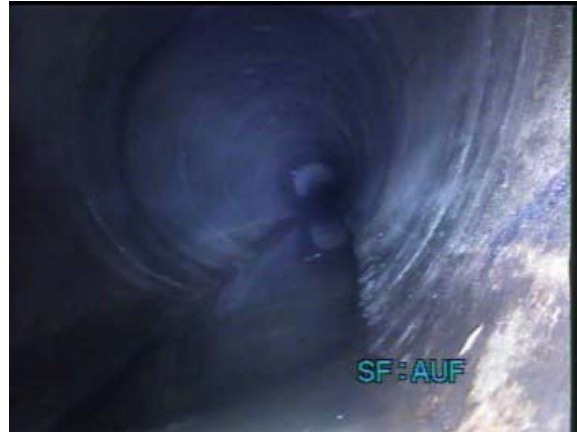
Bild 73: Ablagerungssituation nach der Reinigung
