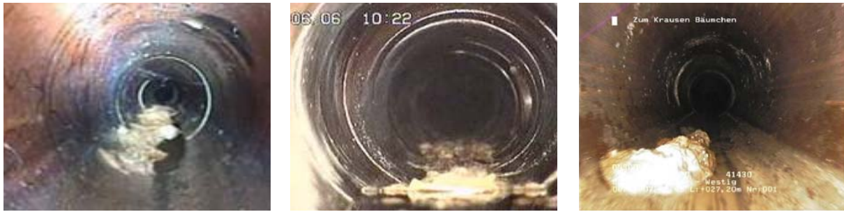
Bild 54: Ablagerungshöhe >15 % der Querschnittshöhe, Auswertungsbeispiele zu Fällen ohne Einschränkung der hydraulischen Leistungsfähigkeit und hoher Wahrscheinlichkeit für die Remobilisierung durch zeitweise erhöhte Abflüsse
