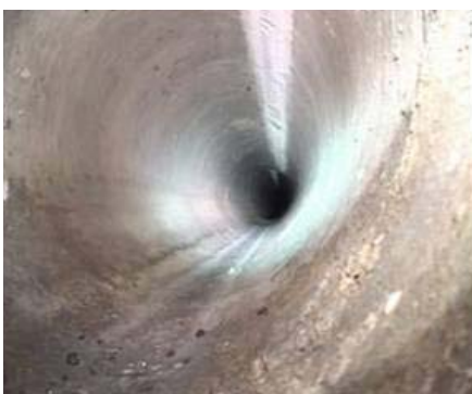
Bild 48: Untersuchter Abwasserkanal (Beton, DN 300, RW, 15-Jahre ohne Reinigung)
