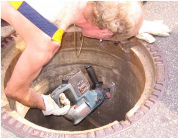
Bild 86: Montage von Schachterkennungssystemen im Schachthals, Beispiel
