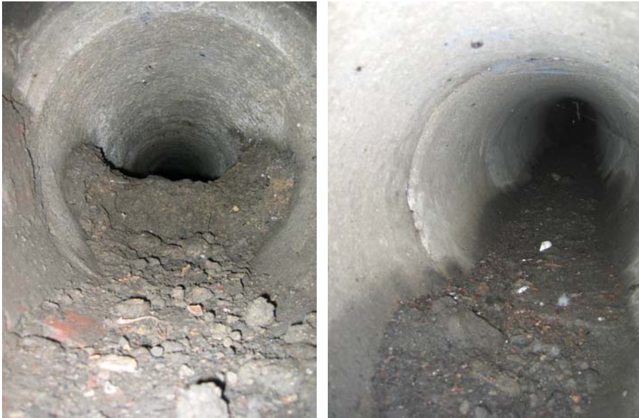
Bild 140: Quellen einer Geruchsbildung: verfestigte Ablagerungen als Hindernis (links), Ablagerungen oberhalb des Hindernisses (rechts), EZG Kleingartenweg, Eislebenerstrasse, Haltung 148-147, DN300/B
