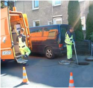
Bild 150: Inspektion der im Schacht angeschlossenene Haltungen
