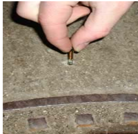
Bild 19: Glasröhrchentransponder im Asphalt (Bodemann GmbH)
