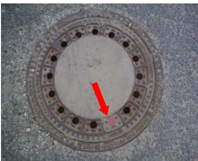
Bild 30: Pfropfen (rot) im Kanaldeckel zur Angabe der Entwässerungsart und der Fließrichtung
