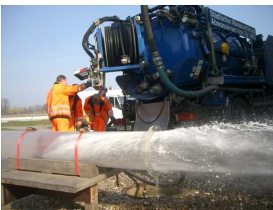
Bild 79: Druck- und Durchflussmessung an einem Reinigungsfahrzeug mittels MID und Druckaufnehmer; Beispiel für aufgezeichnete Messkurven.
