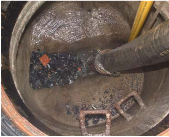
Bild 70: hoher Feststoffeintrag aus einer Baumaßnahme
