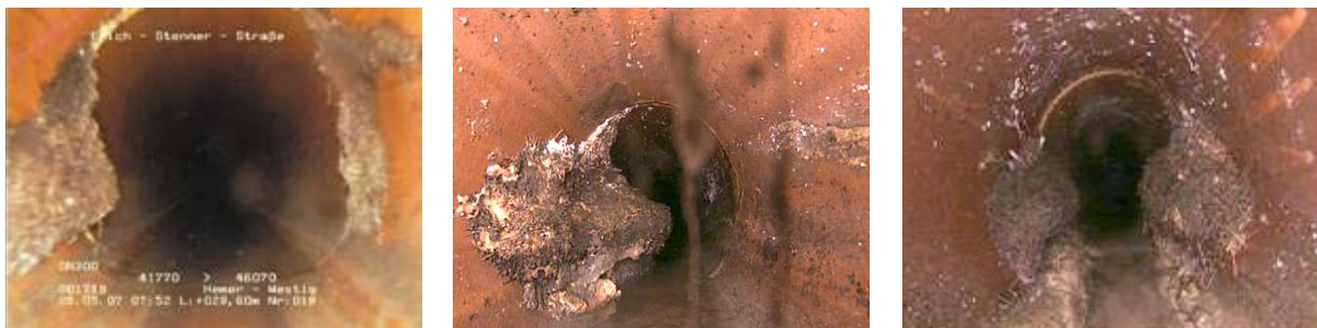
Bild 55: Wurzeleinwüchse in Abwasserkanäle
