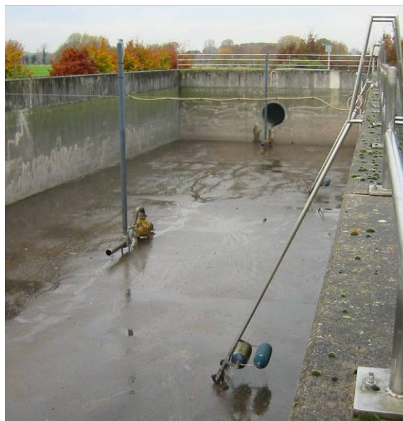
Bild 4.1: Regenbecken als offenes Durchlaufbecken im Nebenschluss, Hoetmar
