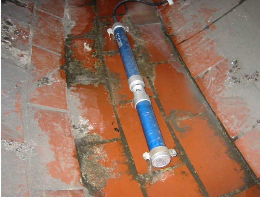
Verwendete Multispektrometersonde im Zulaufkanal des Regenüberlaufbeckens
