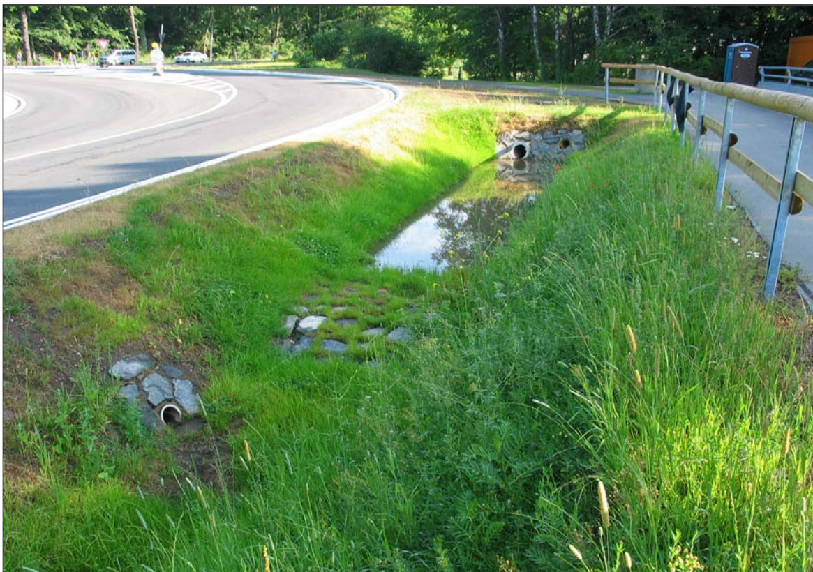
Bild 2: Versickerungsgraben, Blick in Längsrichtung auf Querriegel aus Wasserbausteinen zwischen Versickerungsgraben und Absetzgraben mit Dauerstaubereich
