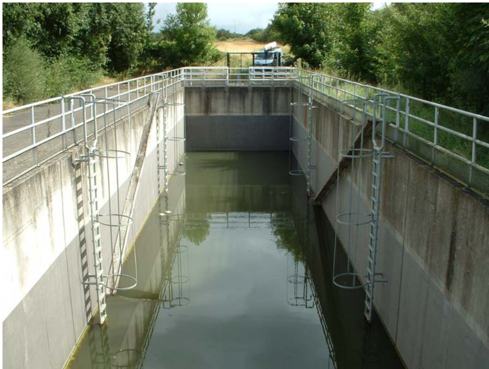
Bild 4.17: Abscheideanlage nach RiStWag in massiver Ausführung, Blick über das Becken auf die Abflusstauchwand
