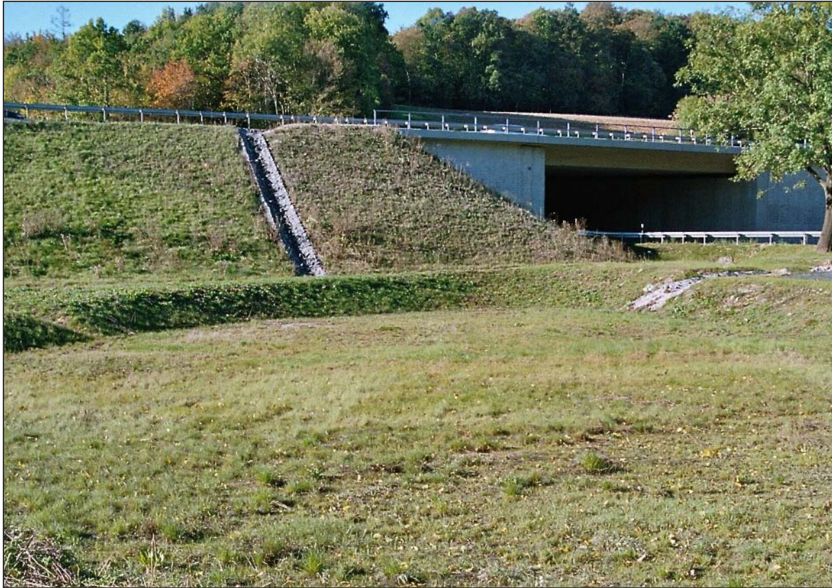
Bild 4.3: Großflächige Versickerung als dezentrale Versickerungsanlage mit punktuellm Zulauf (Bildhintergrund Straßenböschung und rechter Bildrand) (VA1)
