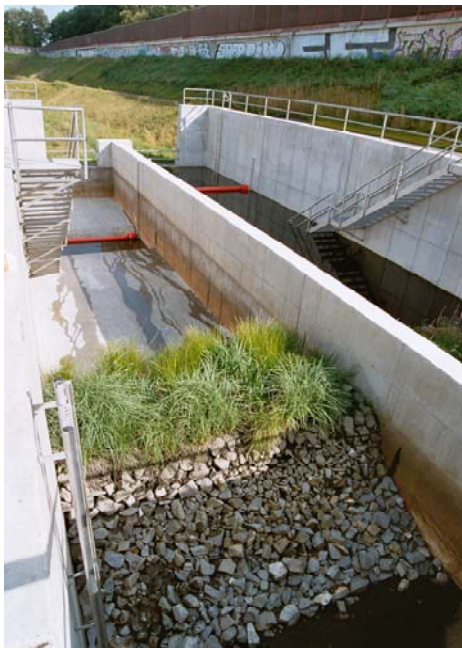
Bild 2: Zweizüiges Betonabsetzbecken mit Tosbecken und schwimmender Tauchwand vor Retentionsbodenfilterbecken; Trennung Tosbecken und Absetzbereich durch Natursteinriegel mit "Pflanzmulde"
