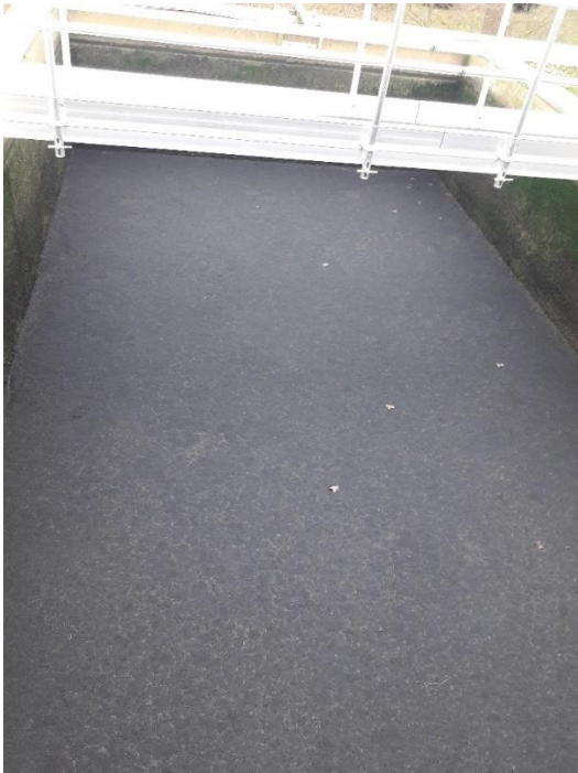
Abbildung 14: GAK-Filter auf der KA Gütersloh-Putzhagen (Draufsicht)
