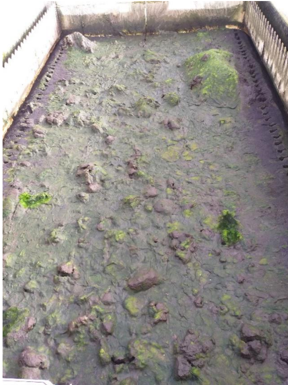
Abbildung 35: Filteroberfläche vor Luftspülung
