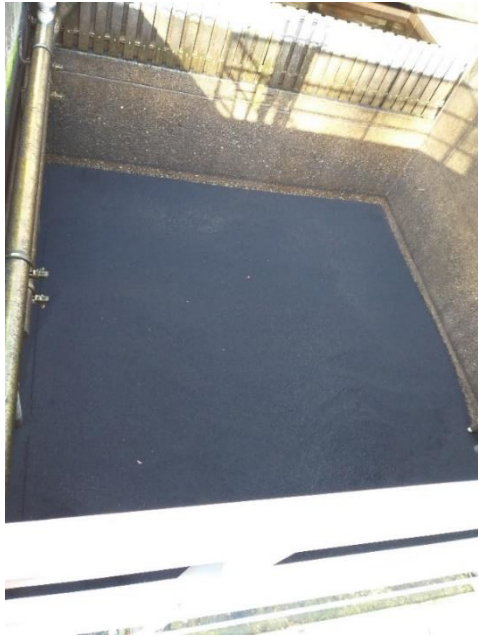
Abbildung 18: GAK-Filter auf der KA Köln-Rodenkirchen (Draufsicht)
