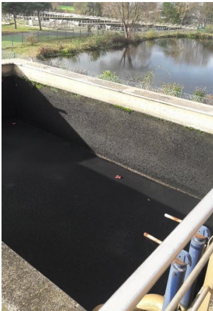
Abbildung 16: GAK-Filter mit dahinterliegendem Schönungsteich auf der KA Obere Lutter (Draufsicht)
