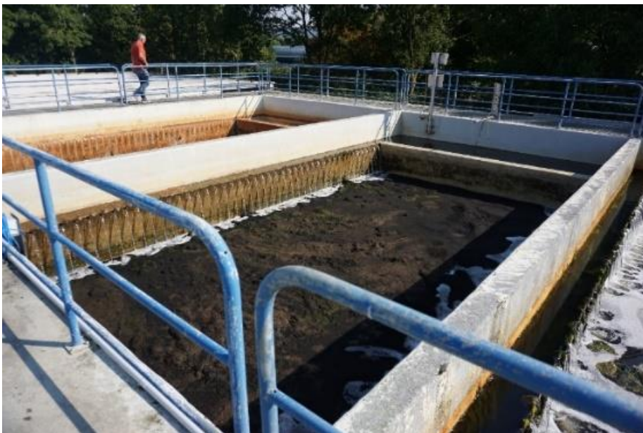
Abbildung 12: GAK-Filter auf der KA Bad Oeynhausens (Draufsicht)
