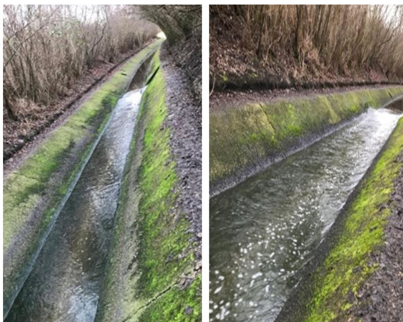
Abbildung 15: Einleitungsstelle der KA Frechen in den Frechener Bach links am 16.01.2019 (Regenwetter) rechts am 11.02.2019 (Regenwetter)
