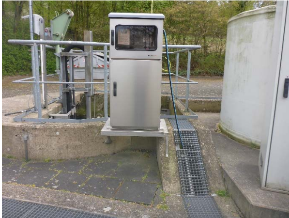
Abb. 6-6: Messstelle 2 - Schacht zwischen Sandfang und Belebung
