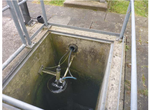
Abb. 6-7: Messstelle 3 - Ablauf Nachklärung
