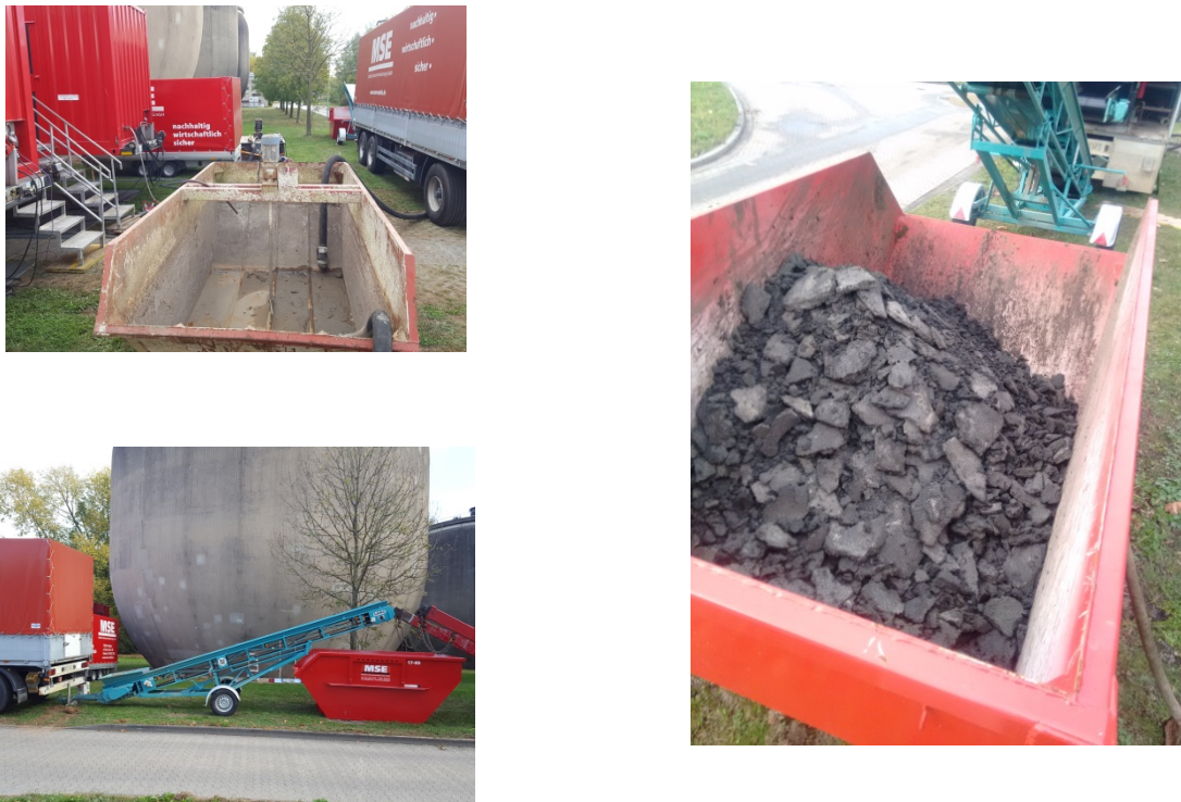
Abbildung 2-6: Mulde mit integriertem Rührwerk zur Einmischung von Filtrationshilfsmittel, Austragsband KFP, Filterkuchen in Mulde
