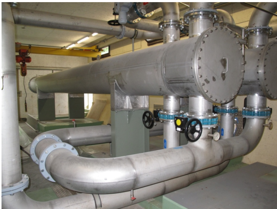
Bild 3-23: Bündelrohrwärmetauscher 2 x 700 kW: gereinigtes Abwasser der Kläranlage Region Bern AG (Ryser Ingenieure AG)
