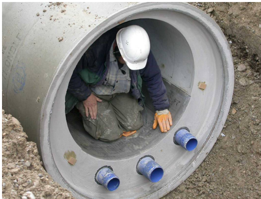
Bild 3-17: Im Rohr eingebauter Wärmetauscher – Wässerwiesen
