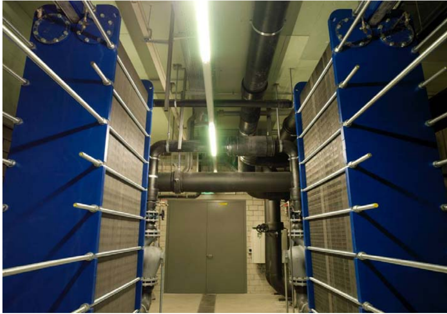
Bild 3-22: Freeflow-Plattenwärmetauscher Post Mülligen (ewz)
