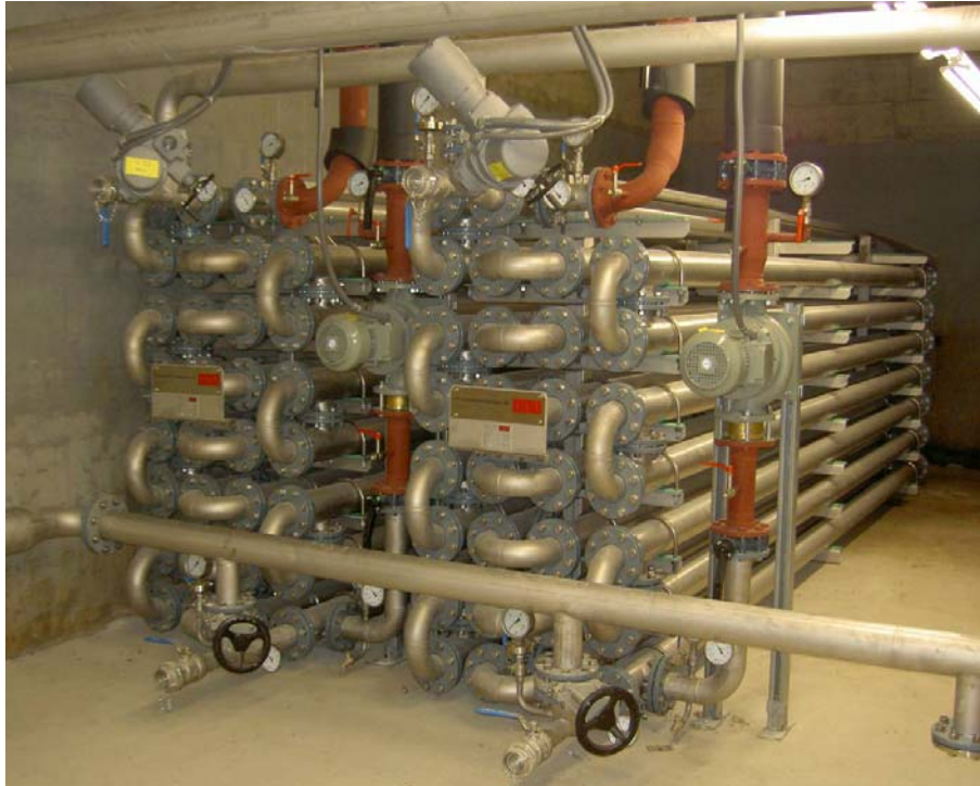
Bild 3-21: Doppelrohrwärmetauscher Rohabwasser (Brünnen Nord)
