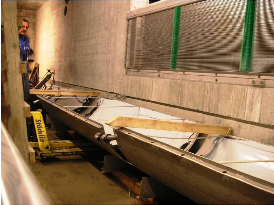
Bild 3-18: Wärmetauschereinbau RÜB Mühleplatz Lyss (KASAG AG, Langnau (CH))
