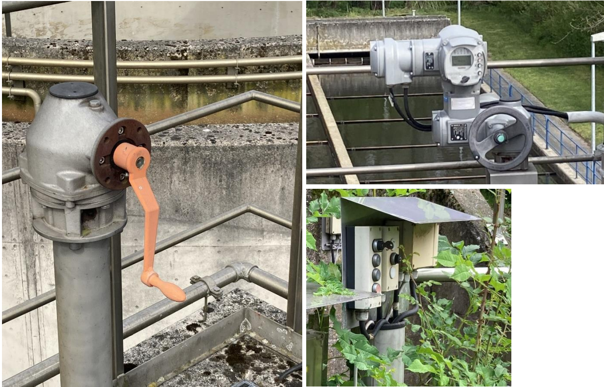
Abbildung 3-23: Arten von Schiebern: links: Schieber nur mit Handrad ohne elektrischen Anschluss (Handrad befindet sich am Schieber), oben rechts: elektrischer Schieber mit Handrad und Druckknopf zur Änderung auf den Handbetrieb, unten rechts: elektrischer Schieber mit Schlüssel für Handverstellung. (eigene Aufnahmen)
