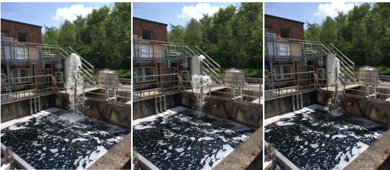
Bild 9: Abwasser-Geysir aus Entlüftungsleitung
