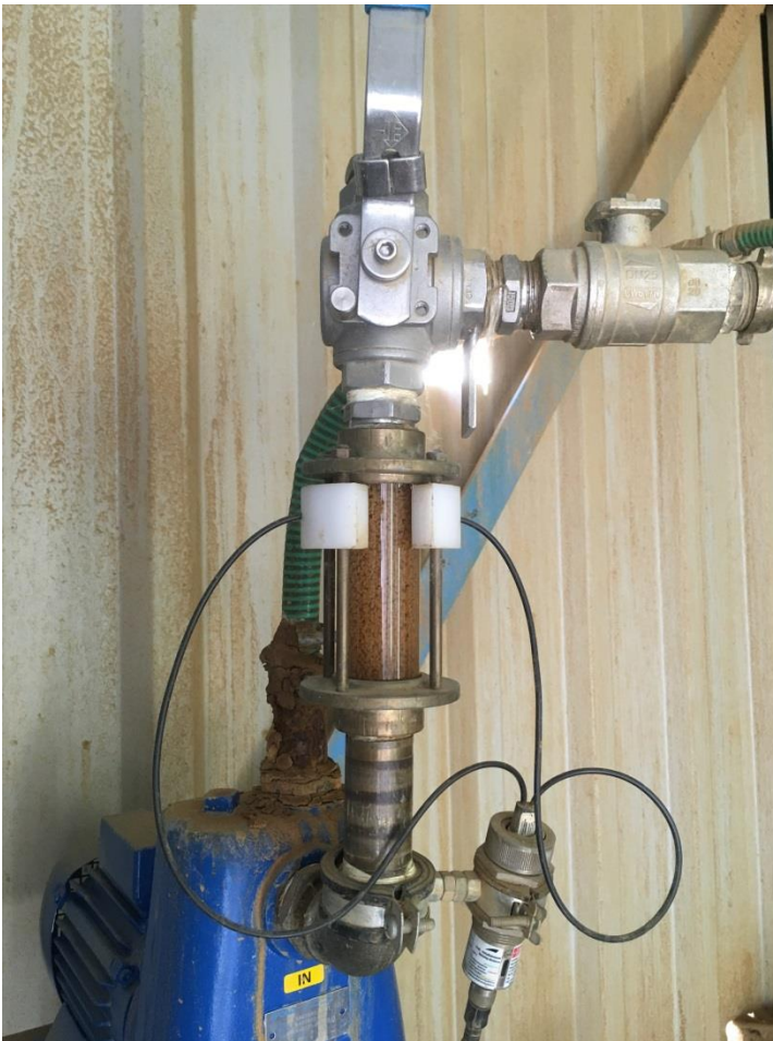
Abbildung A-7: Regelungstechnik zur Flockungsmitteldosierung auf der Kieswäsche Gymnich
