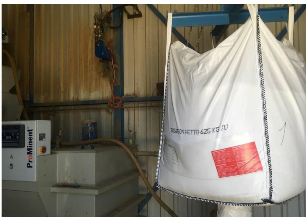
Abbildung A-3: Dosierstation auf der Kieswäsche Gymnich
