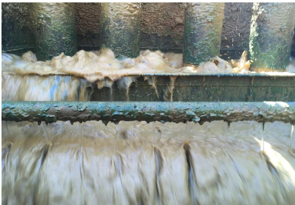
Abbildung A-2: Zugabe der Flockungsmittellösung zum KWW. Die Verteilung über den Wasserstrom erfolgt über mehrere Löcher (Bildmitte); Kieswäsche Gymnich
