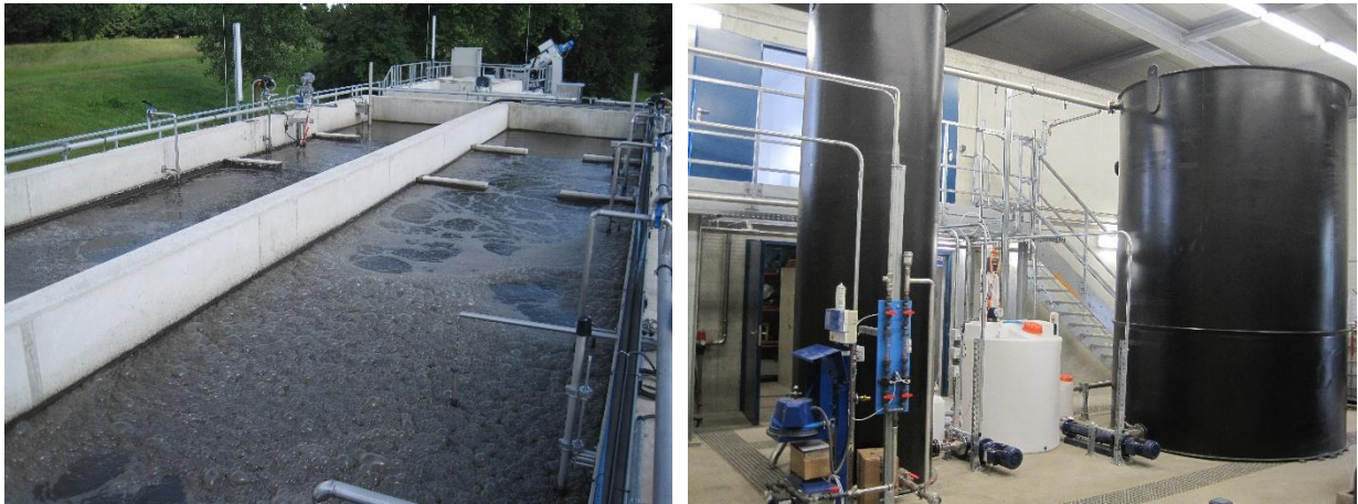
Abbildung 1 Blick auf die Belebtschlammstraßen (links) und die PAK-Stufe (rechts) auf dem Technikum der Kläranlage Emschermündung (Emschergenossenschaft)
