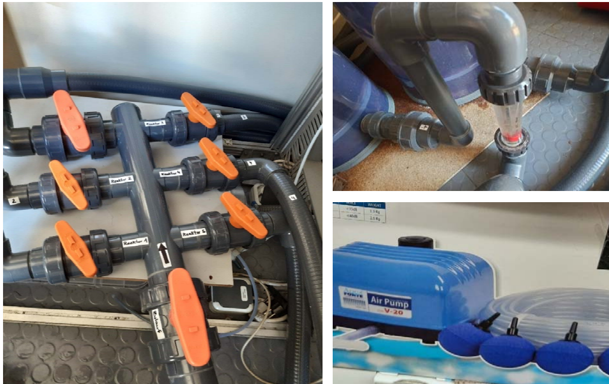
Abbildung 4: Verteilung auf die einzelnen Reaktoren (links), Durchflussmesser (oben rechts) und Belüftung (unten rechts) der einzelnen Reaktoren.
