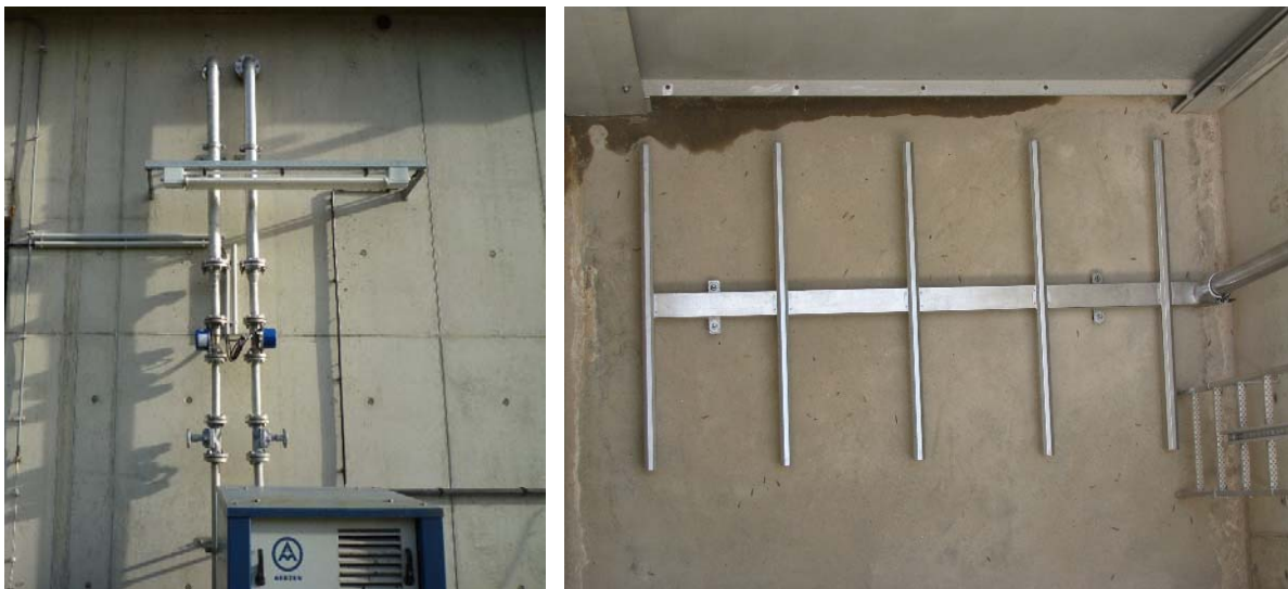
Abbildung 9: Vorhandenes Drehkolbengebläse (links) und vorhandene Belüftung im Wirbelbett (rechts) (Quelle: Sweco).
