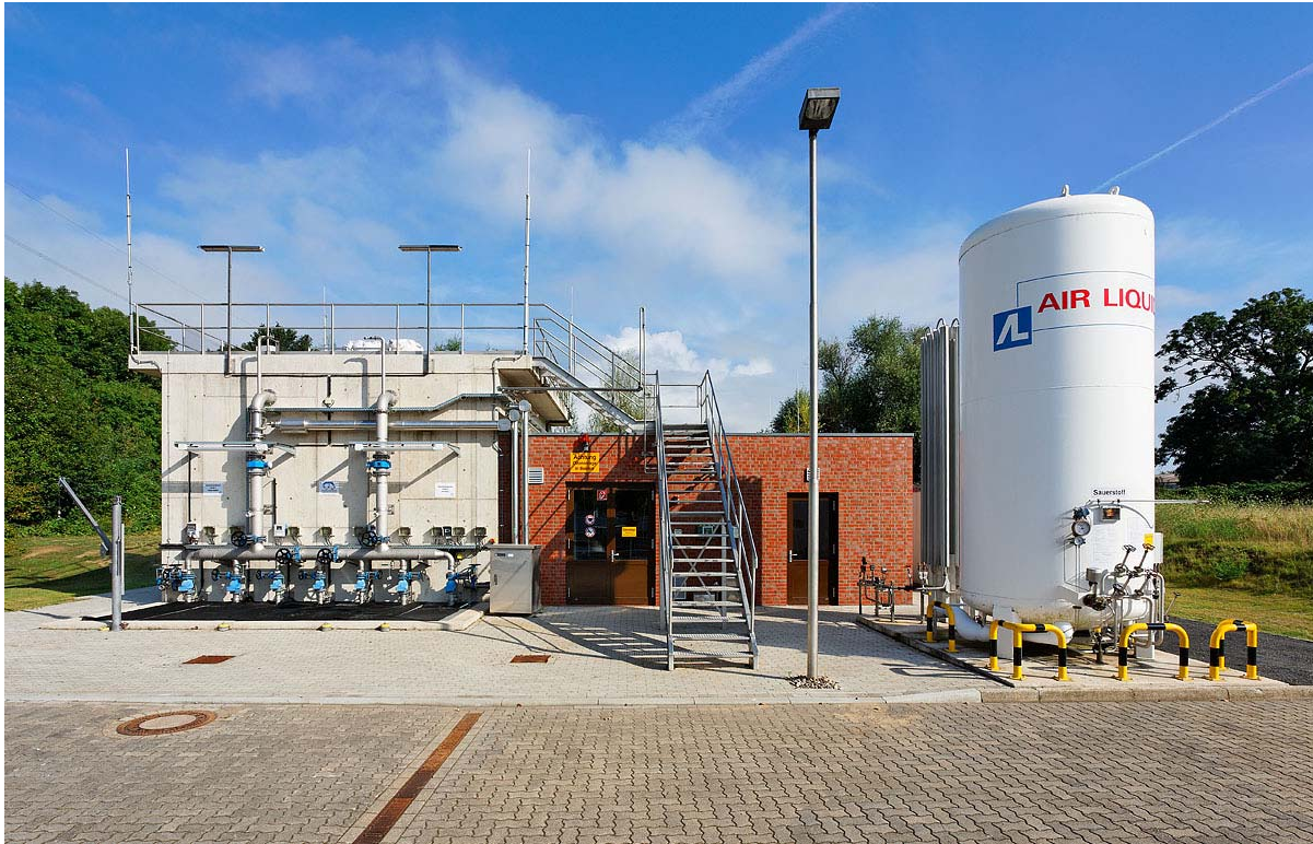
Abbildung 1: Ozonung auf der Kläranlage Duisburg-Vierlinden (Quelle: Sweco).
