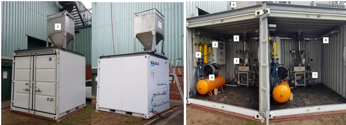
Bild 9.10: Beispiel eines PAK-Lager- und Dosierbehälters (AK-Dos, Fa. Sülzle-Kopf) von außen (links) und Innenansicht des Containers (rechts)
