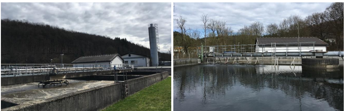
Abbildung 2.2: Belebungsbecken und Nachklärbecken 1
