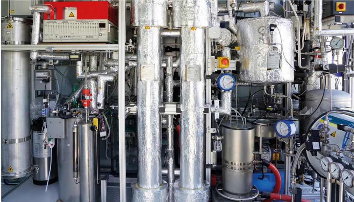
Abbildung 5: Innenansicht der WaStraK-Anlage
