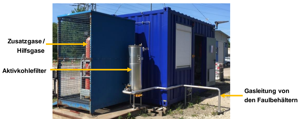
Abbildung 7: Außenansicht der WaStrak-Anlage mit Rohgasaufbereitung
