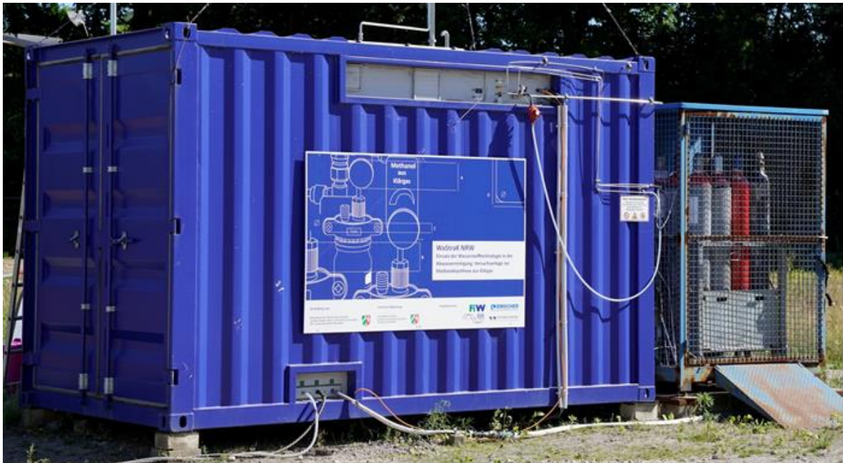
Abbildung 4: Außenansicht der WaStrak-Anlage
