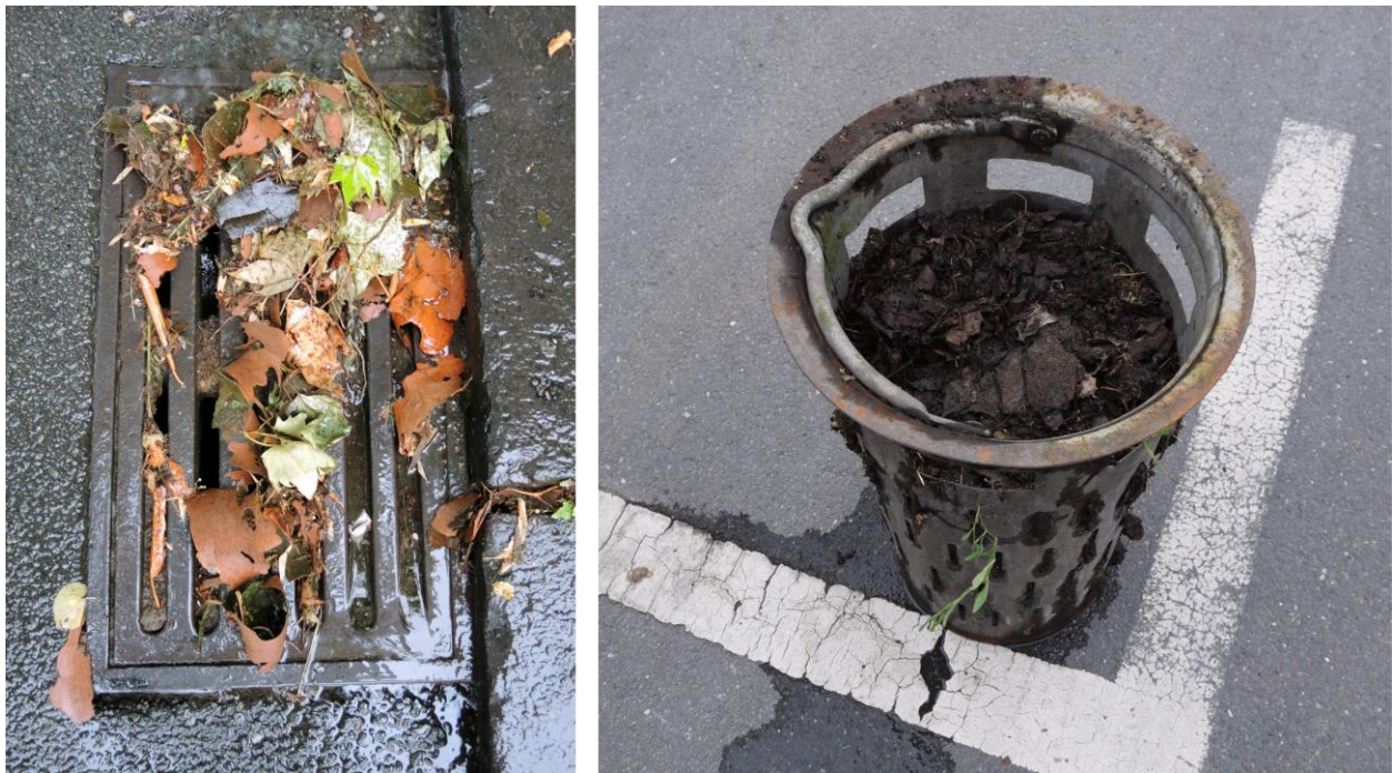
Abbildung 1: Verlegter Straßenablauf-Aufsatz (links) und gefüllter Schlammeimer (rechts)
