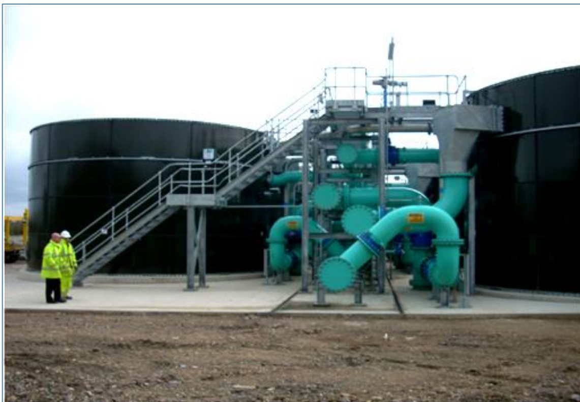
Abbildung 8: Großbritannien – Kläranlage Swindon, Einsatz von granulierter Aktivkohle
