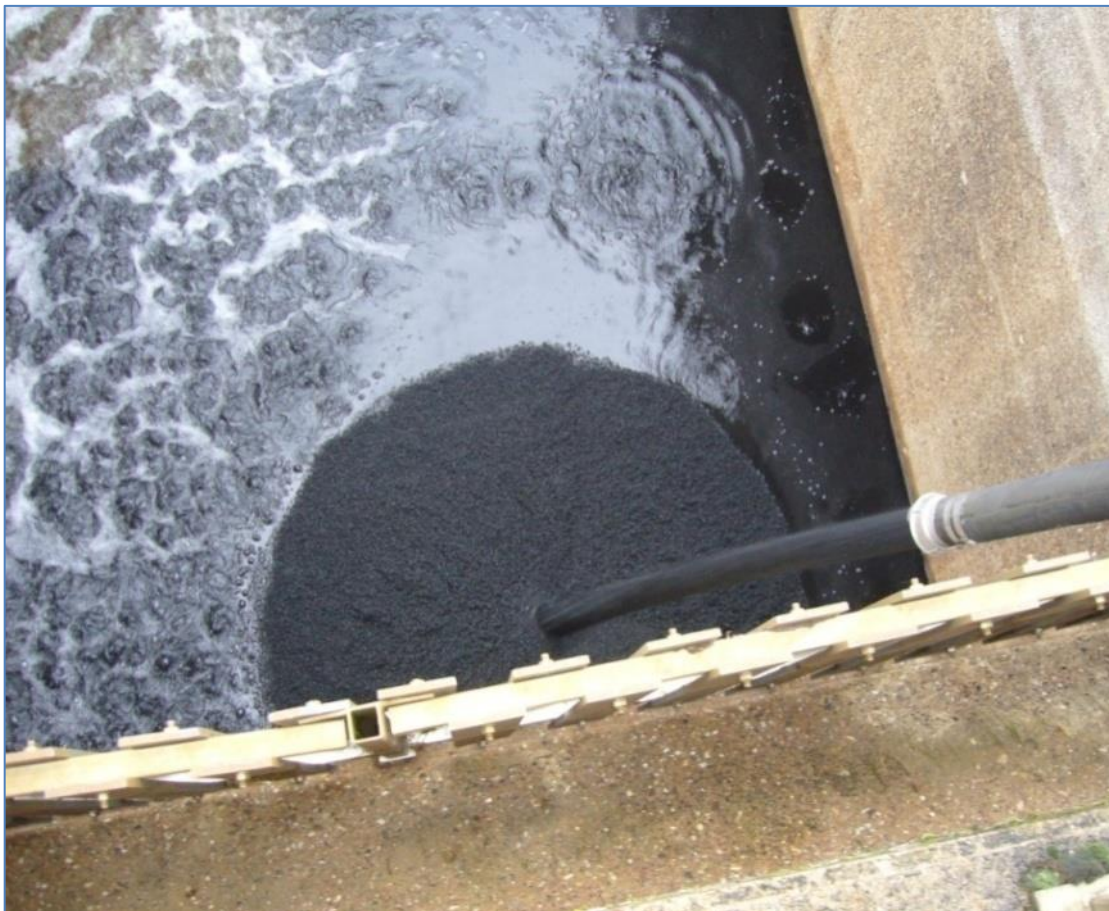
Abbildung 11: Verbandsklärwerk Obere Lutter – Füllung der Filterzelle mit granulierter Aktivkohle
