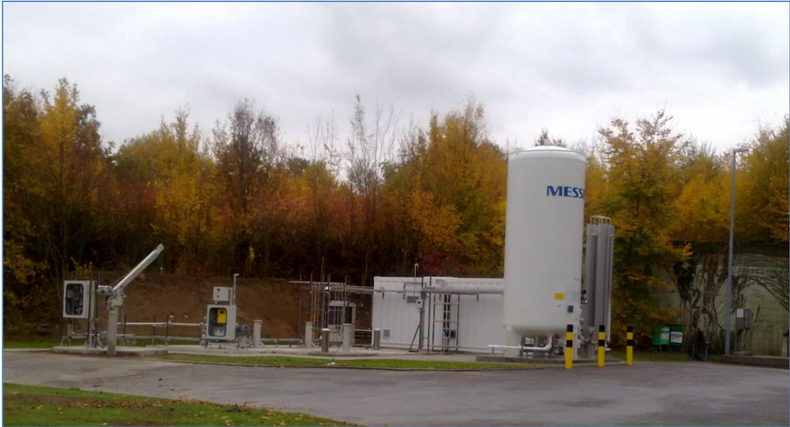
Abbildung 17: Kläranlage Bad Sassendorf – Ozonanlage mit Sauerstofftank
