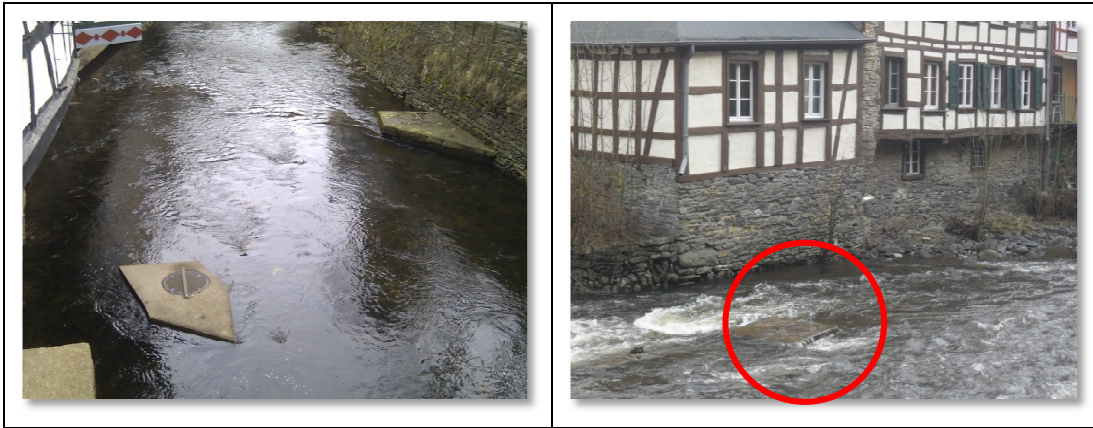
Abbildung 2: Schachtdeckel im Fließweg der Rur Abbildung 3: überströmter Schachtdeckel
