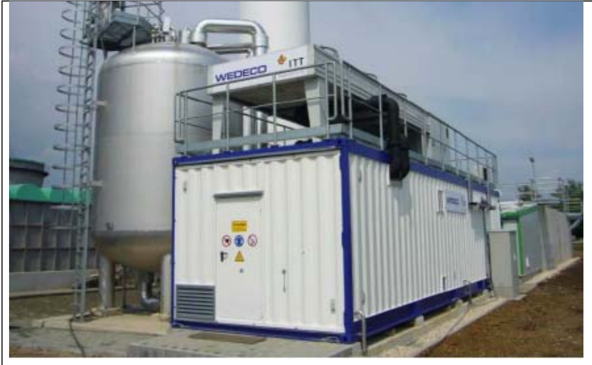
Bild 51: Beispiel Aufstellung Ozongenerator in Container (Quelle: Fa. Xylem)
