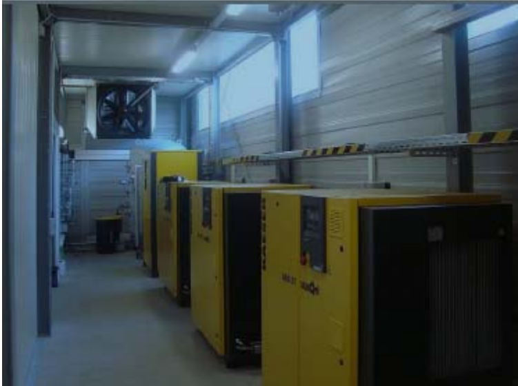
Bild 43: Kompressorstation (Quelle: Fa. Nordic Water)
