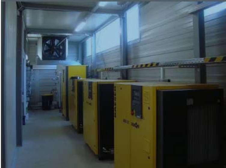
Bild 42: Kompressorstation (Quelle: Fa. Nordic Water)
