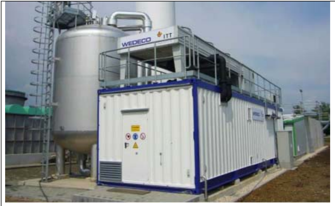
Bild 50: Beispiel Aufstellung Ozongenerator in Container (Quelle: Fa. Xylem)
