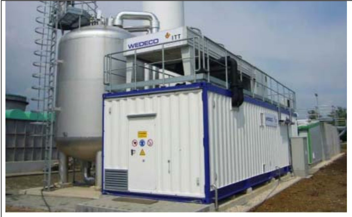
Bild 46: Beispiel Aufstellung Ozongenerator in Container (Quelle: Fa. Xylem)
