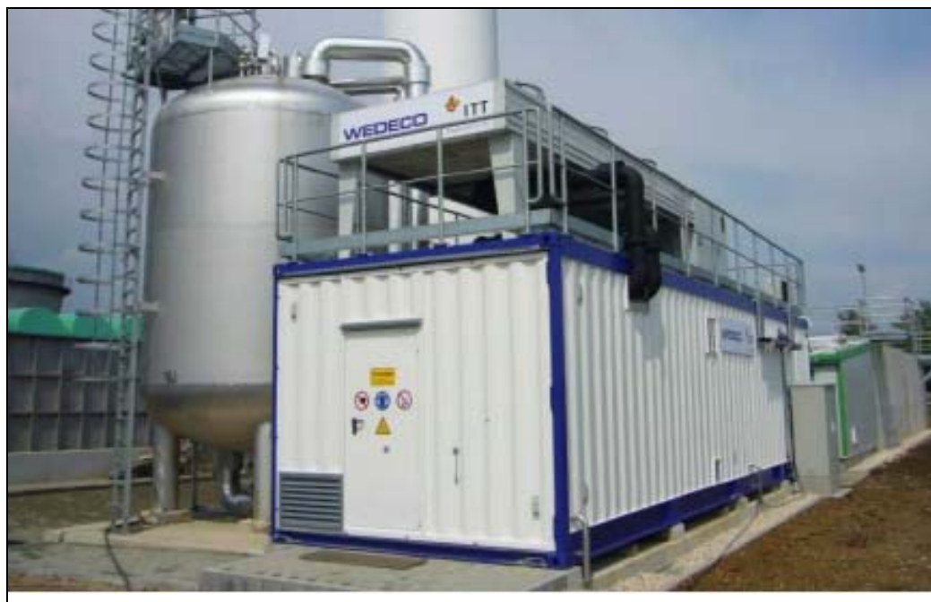
Bild 18: Beispiel Aufstellung Ozongenerator in Container (Quelle: Fa. Xylem)
