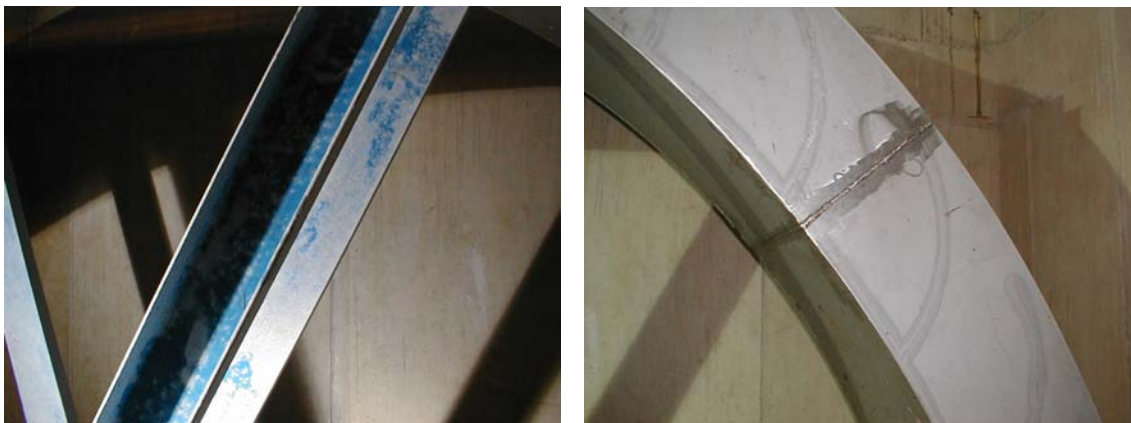
Bild 7.5: Fortgeschrittene Korrosion am Wasserrad nach 14 Monaten in Kanalatmosphäre – von links nach rechts – Tragarm des Wasserrades mit Weißrost, Schweißnaht des Wasserradkastens mit Rostansatz
