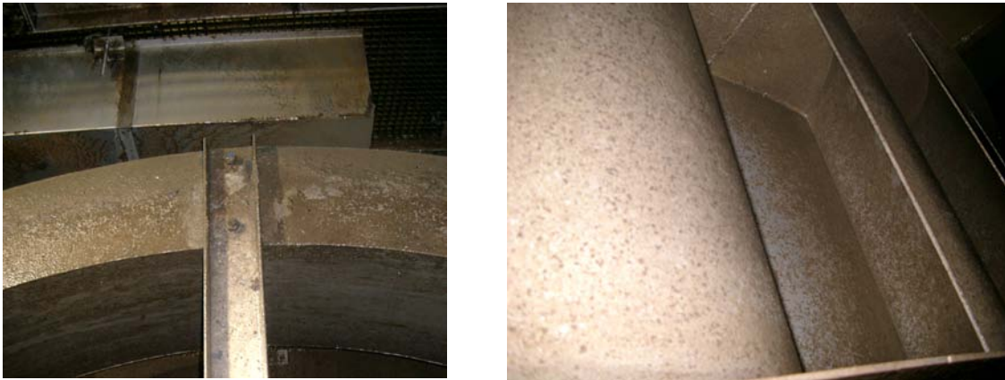
Bild 7.3: Zulaufgerinne zum Wasserrad mit Wasserradkasten sowie Einblick in eine Wasserradtasche (24 Monate nach Inbetriebnahme ohne Reinigung)
