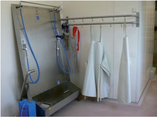
Hygieneschleuse in einem handwerklichen Betrieb
