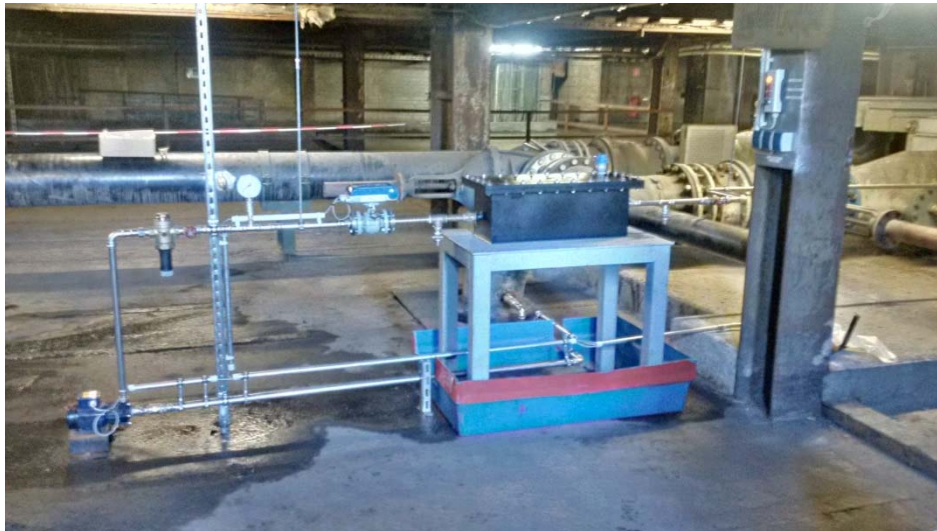
Abbildung 4: Installationen des Schwebstoffsammelkastens auf Prosper Haniel
