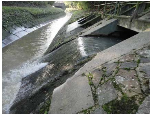
Einleitung in den Borbecker Mühlenbach
