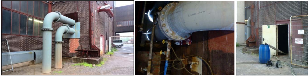
Abbildung 39: Grubenwassermessstellen und Zentrifugenprobenahme Zeche Zollverein, Foto LANUV
