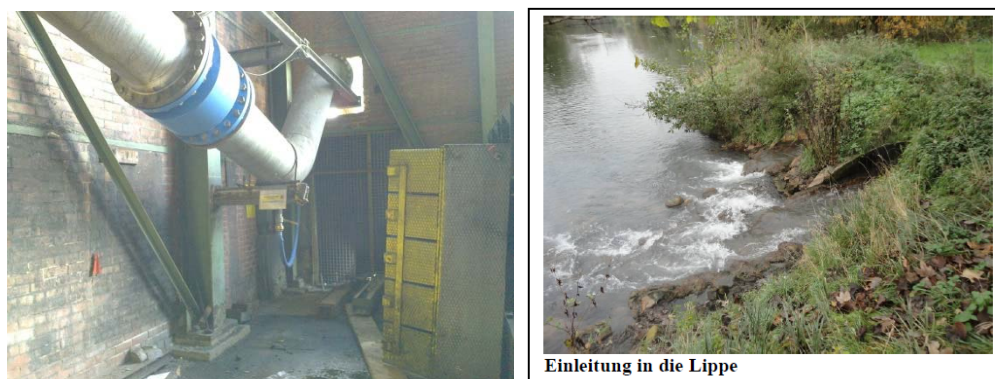
Abbildung 51: Grubenwassermessstelle und Einleitung Zeche Haus Aden, Fotos LANUV und RAG (Einleitung)
