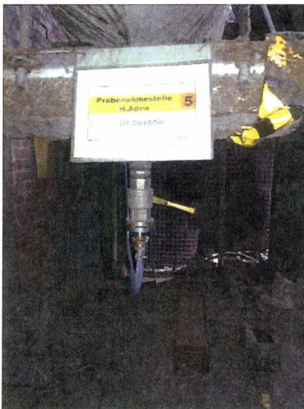
Abbildung 2: Entnahmestelle Grubenwasser Haus Aden mit Direktanschluss der Zentrifuge
