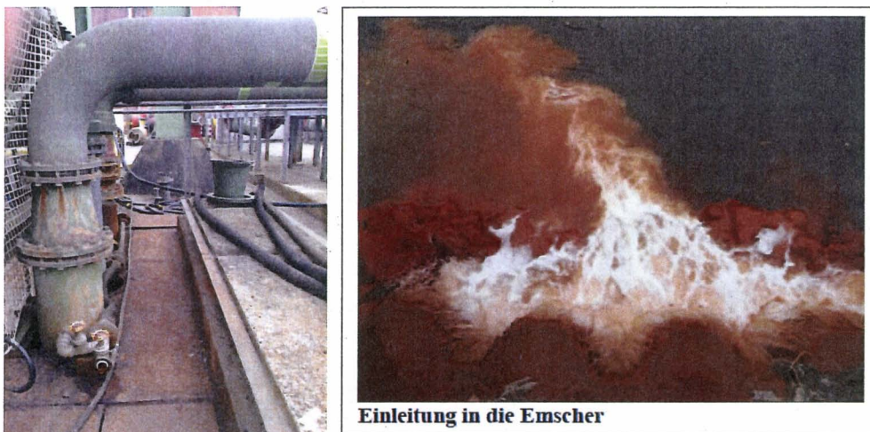
Abbildung 14: Grubenwassermessstelle und Einleitung Zeche Carolinenglück, Foto links LANUV, rechts RAG
